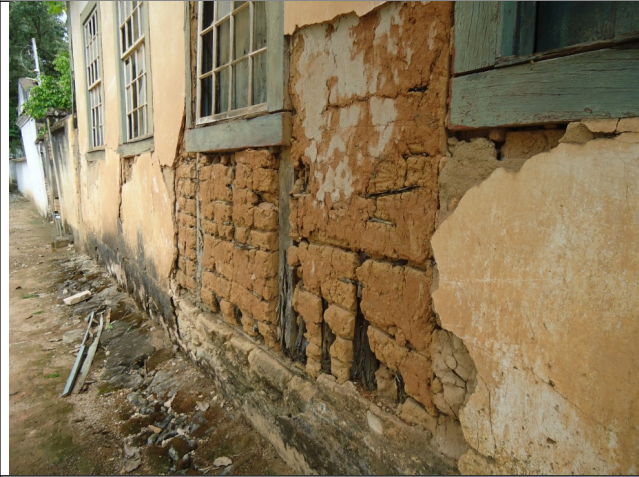
Figura 07 – Descolamento do reboco.
