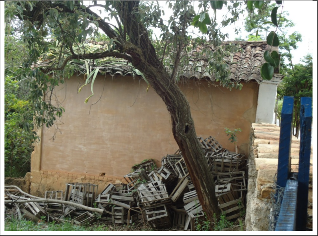
Figura 08 – Terreno adjacente com entulhos e telhado com vegetação invasiva.
