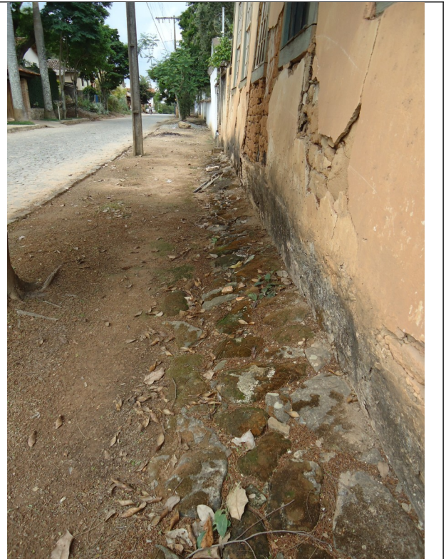
Figura 10 – Infiltrações, trincas e estufamento do
