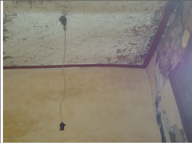
Figura 11– Forro de esteira com fição exposta.
