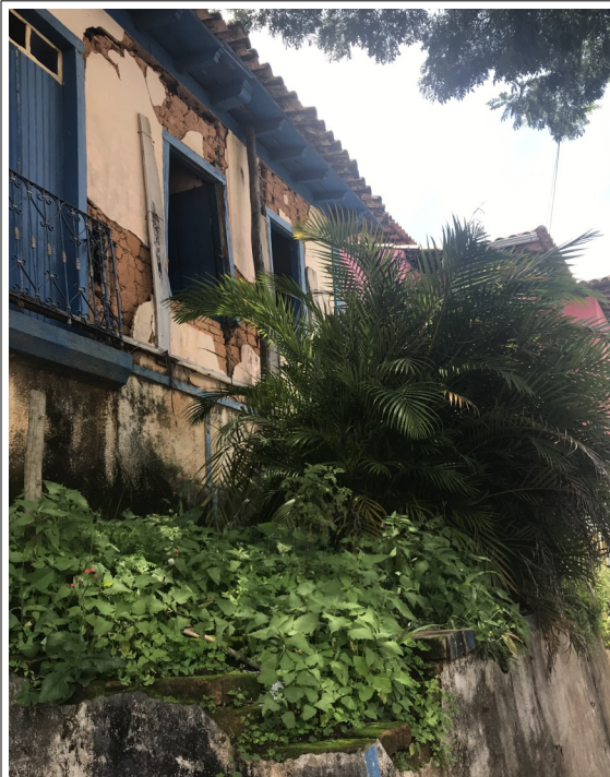
Figura 5 – Esquadrias abertas, expondo o imóvel às intempéries. Presença de muita vegetação no terreno. Fonte: Acervo CPPC.
