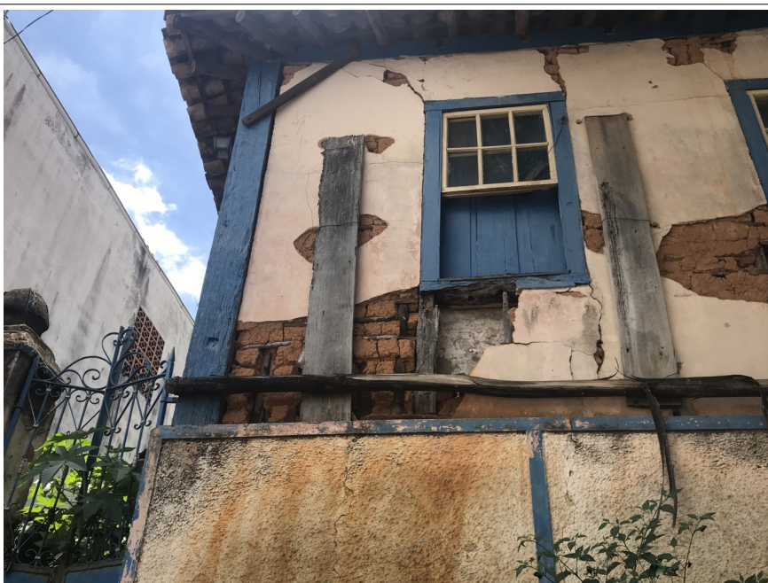
Figura 4 – Comprometimento da trama de madeira e desfazimento do enchimento de barro de trechos das alvenarias de pau a pique. Acervo CPPC.
