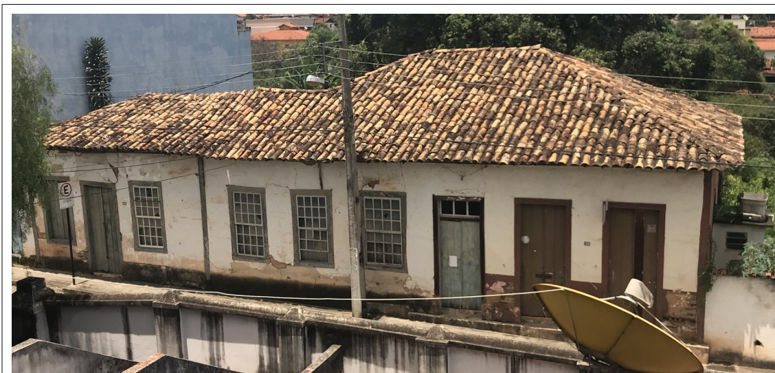
Figura 7 – Aspecto geral da edificação. O telhado apresenta abatimentos e início de arruinamento no trecho esquerdo, fundos. Fonte: acervo CPPC.
