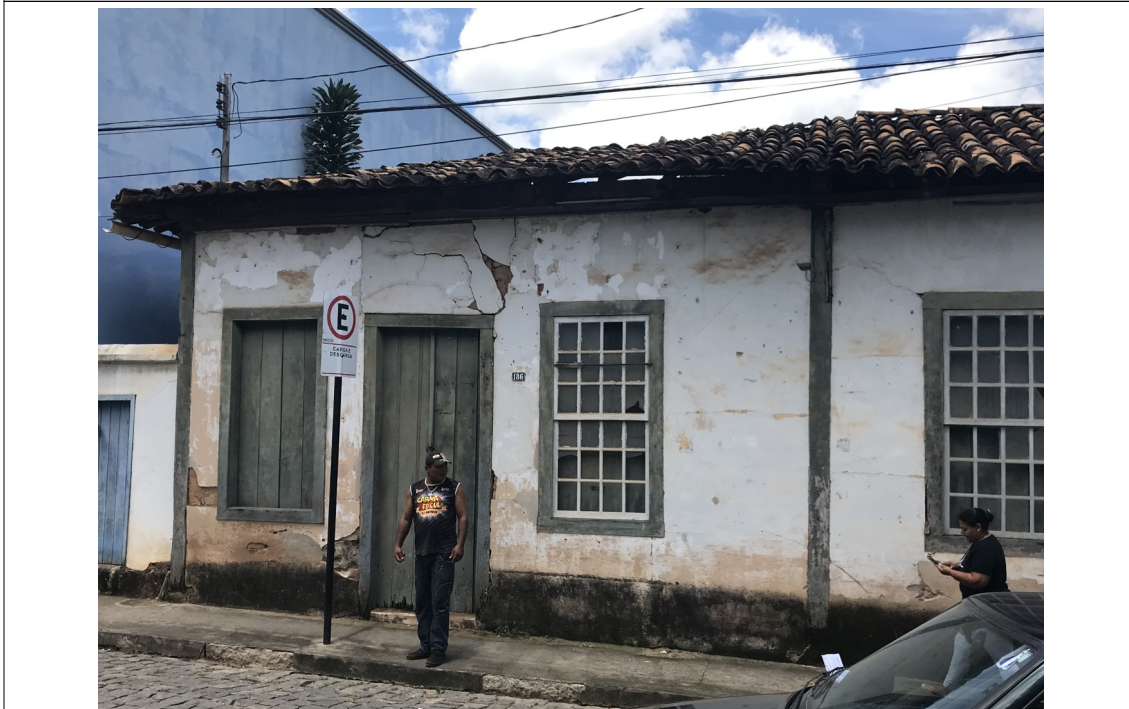
Figura 6 – Estado avançado de degradação do imóvel; é possível notar que a parte posterior do telhado desabou. Trechos com trincas, estufamento e descolamento do reboco. Fonte: acervo CPPC.
