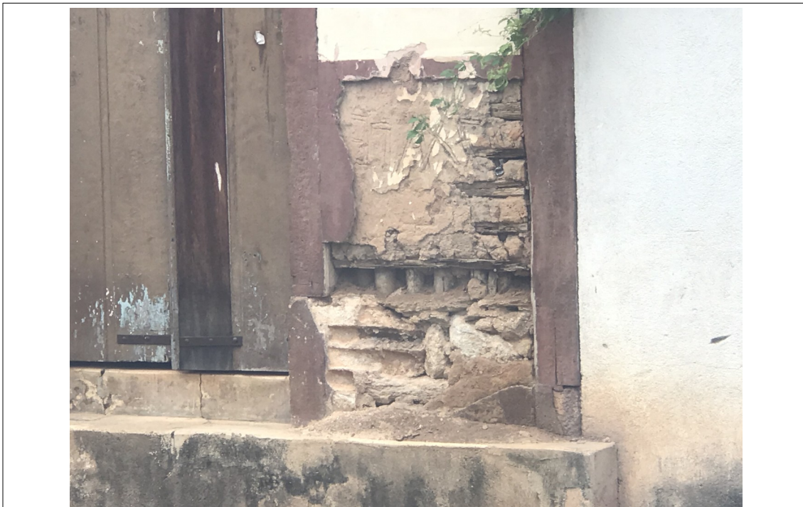
Figura 5 – Comprometimento das vedações de pau a pique, com danos na trama e perda do enchimento. Fonte: acervo CPPC.
