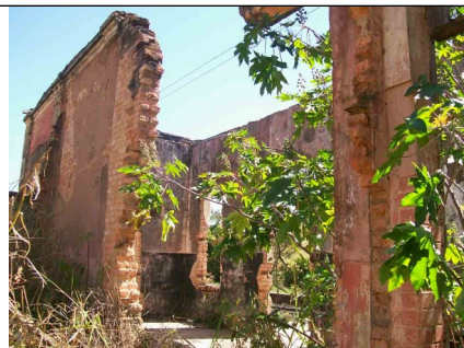
Figuras 14 – Paredes arruinadas.
