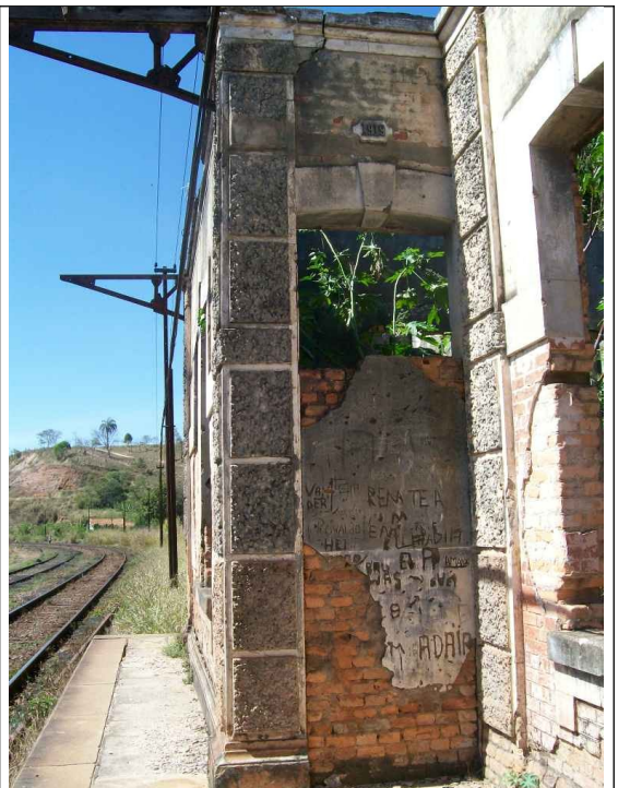
Figura 13 – Alteração na estrutura original, inscrições e vandalismo..
