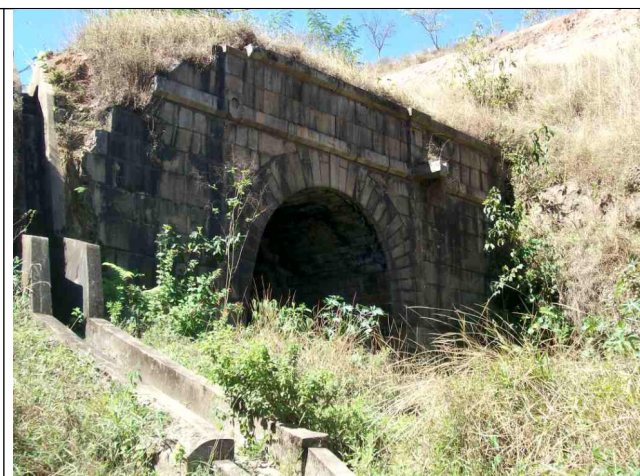
Figura 21 – Túnel, com trecho arruinado.
