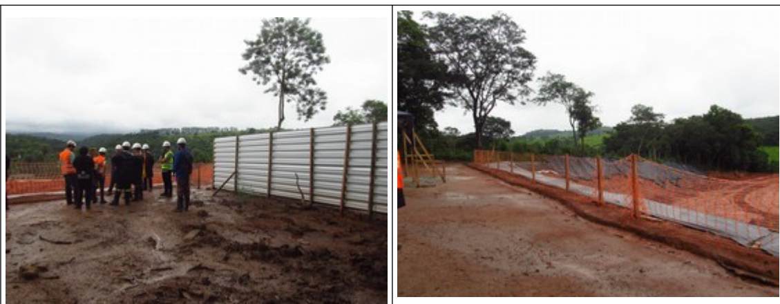
Figuras 11 e 12- Imagens do canteiro de obras nos fundos da Igreja de São Vicente de Paulo em Ponte das Almorreimas. Fotos da vistoria.
