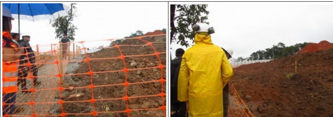
Figuras 1 e 2- Local onde teriam sido identificados os fragmentos cerâmicos nas proximidades do segmento de muro de pedras suprimido no entorno da Igreja de São Vicente de Paulo em Ponte das Almorreimas. Fotos da vistoria.
