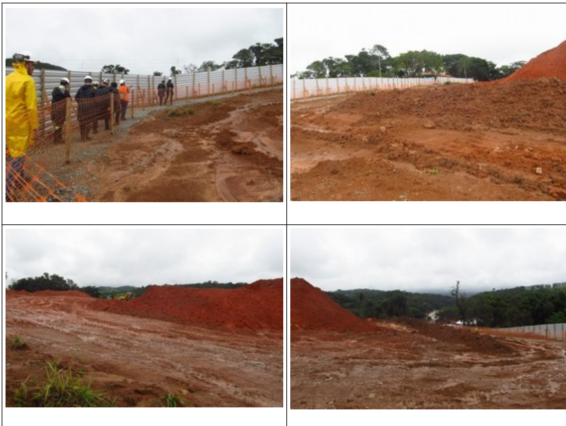
Figuras 3, 4, 5 e 6- Vistoria acompanhando os tapumes metálicos implantados nas proximidades da Igreja de São Vicente de Paulo em Ponte das Almorreimas. Fotos da vistoria.
