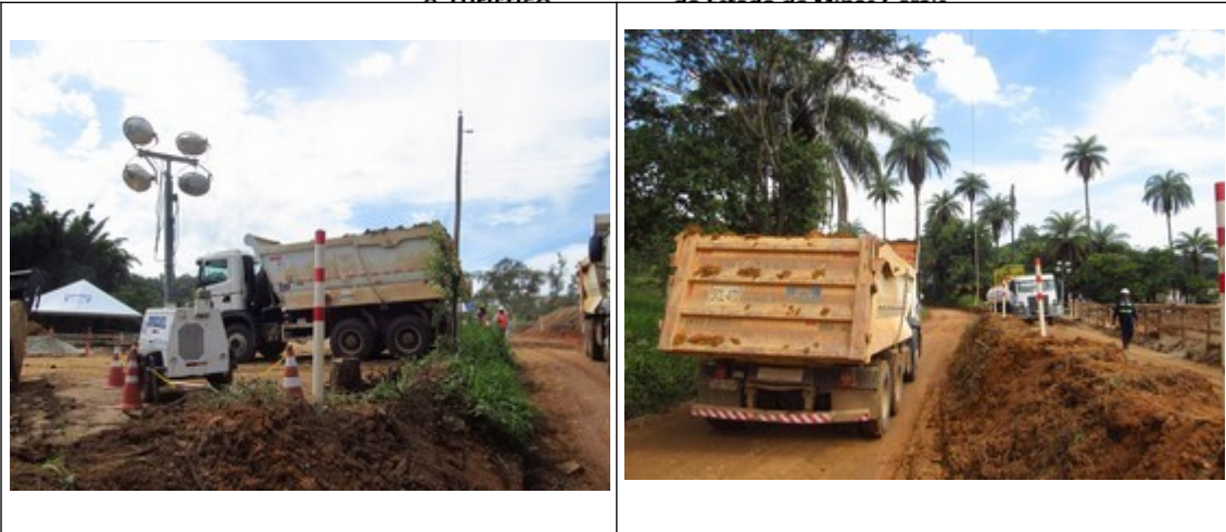
Figuras 12, 13, 14 e 15- Canteiro de obras da nova adutora em Ponte das Almorreimas. Fotos da vistoria.
