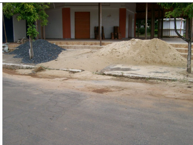
Figura 13 – Material de construção sobre logradouro público.
