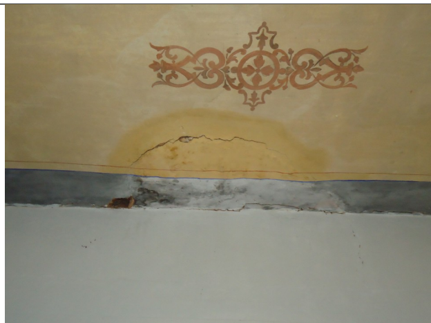
Figura 15 – Dano ao forro da sacristia decorrente do contato do mesmo com a umidade.
