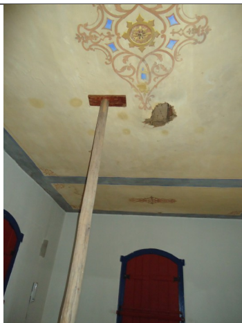
Figura 14 – Forro escorado na sacristia.
