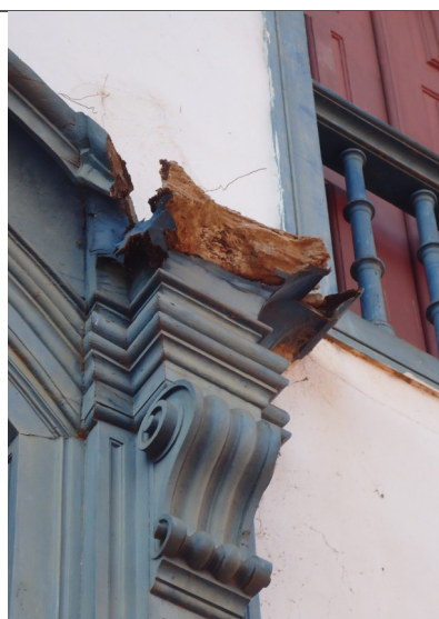
Figura 10 – Elemento danificado na parte superior da portada.
