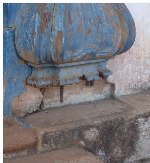
Figura 09 – Elemento faltante na base da portada principal.
