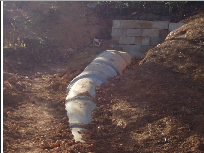
Figura 12 – Canalização de água pluvial nos fundos e lateral direita da edificação.
