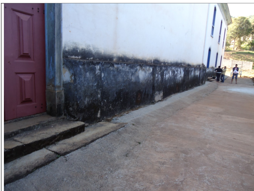
Figura 05 – Manchas de umidade junto à base da fachada lateral direita.
