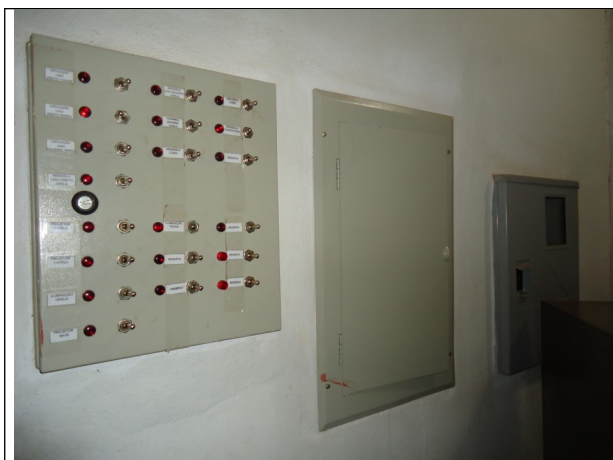
Figura 17 – Instalações elétricas adequadas.
