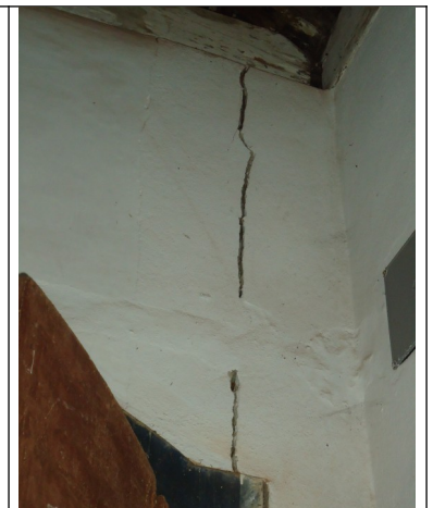
Figura 16 – Trinca existente entre o cômodo atrás do altar a e tribuna no pavimento superior.
