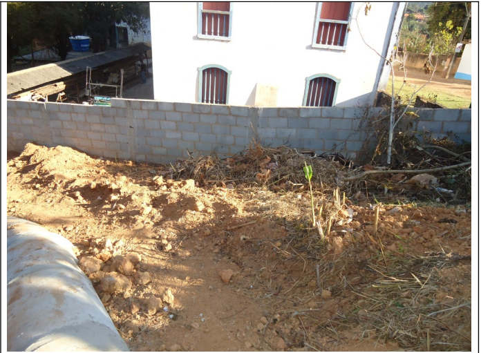
Figura 13 – Muro sem acabamento nos fundos da edificação.
