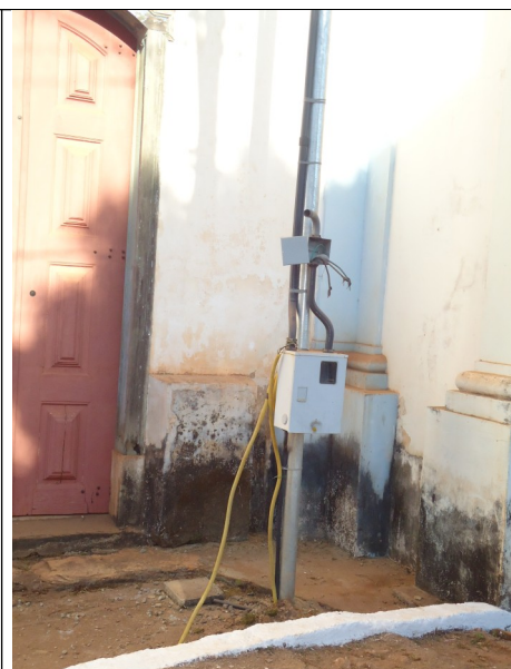
Figura 08 – Padrão em local indevido.
