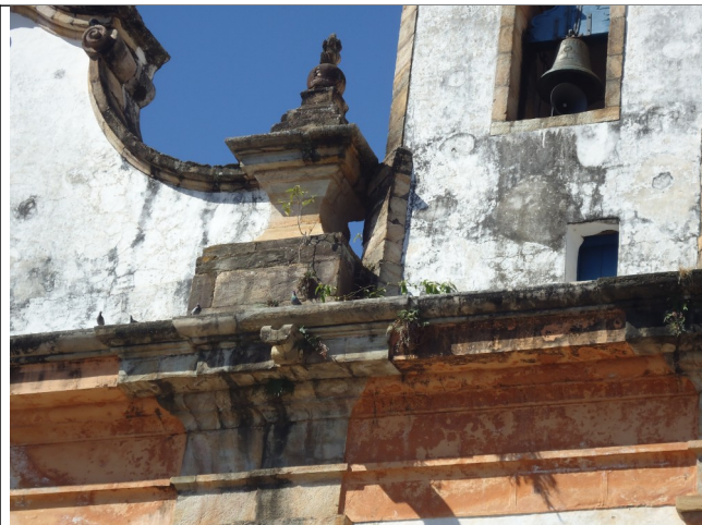
Figura 05 – Manchas de umidade e plantas invasoras.
