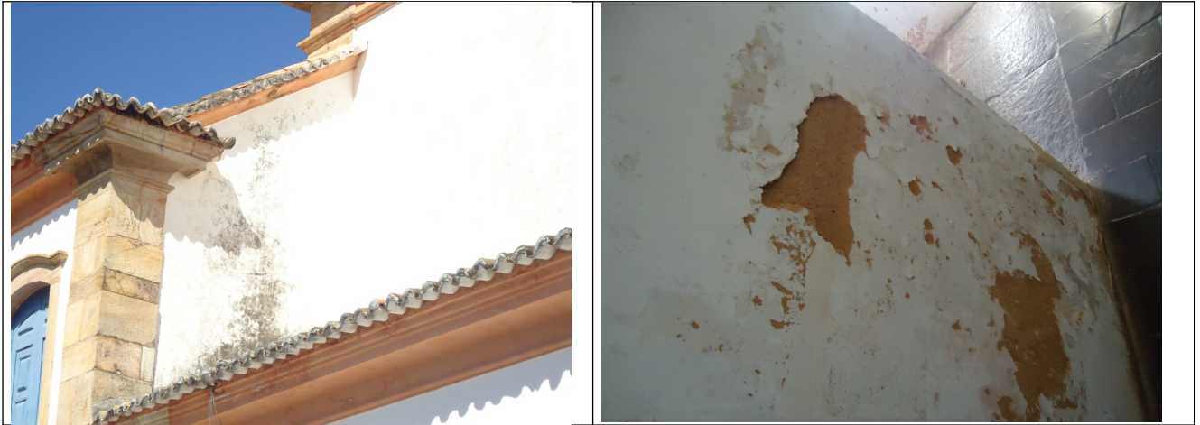
Figuras 07 e 08 – Manchas de umidade e Descolamento pintura.
