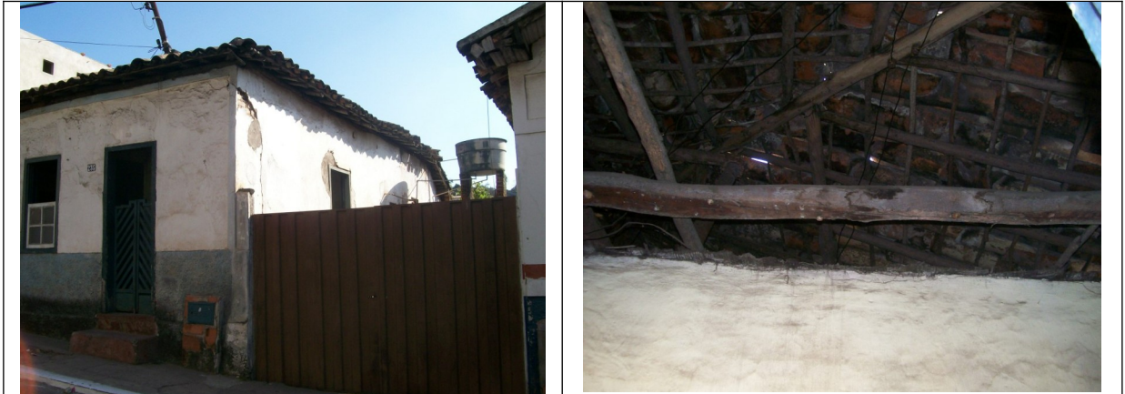
Figuras 5 e 6 – No dia da vistoria verificamos que o telhado necessita de medidas de intervenção. Pois uma parte do imóvel encontra-se sem forro, como pode-se observar na figura 6.
