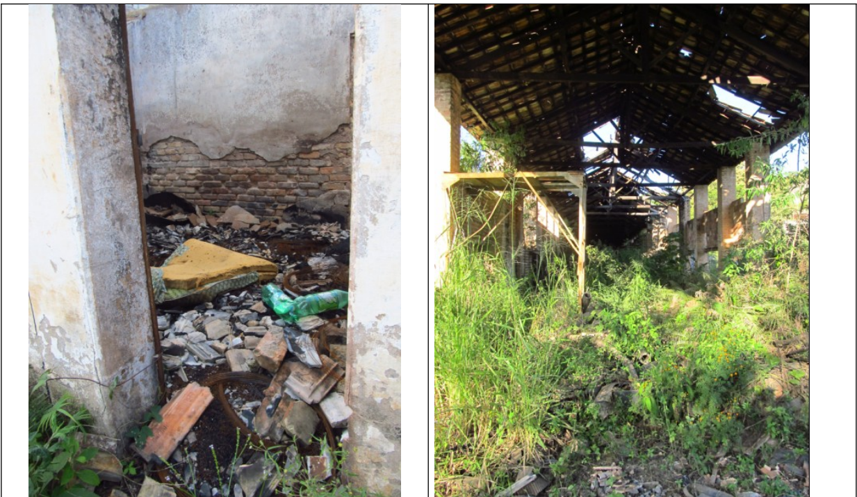
Figuras 44 e 45- Entulhos e vegetação nas edificações na Cerâmica João Pinheiro. Fotos da vistoria.
