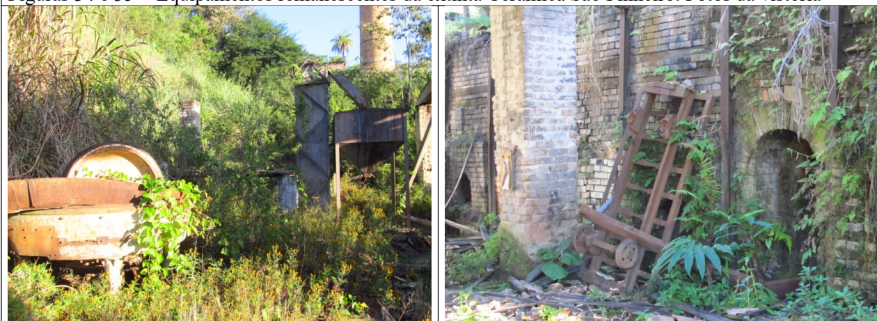
Figuras 236 e 37 - Equipamentos remanescentes da extinta Cerâmica São Pinheiro. Fotos da vistoria.
