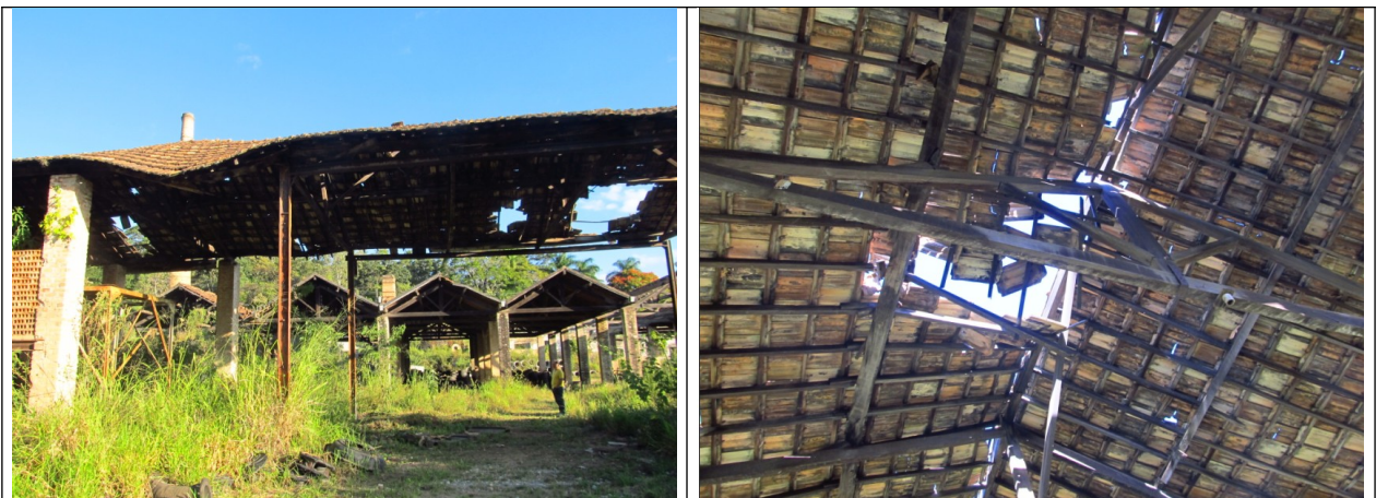
Figuras 40 e 41- Mau estado de conservação das edificações na Cerâmica João Pinheiro. Fotos da vistoria.
