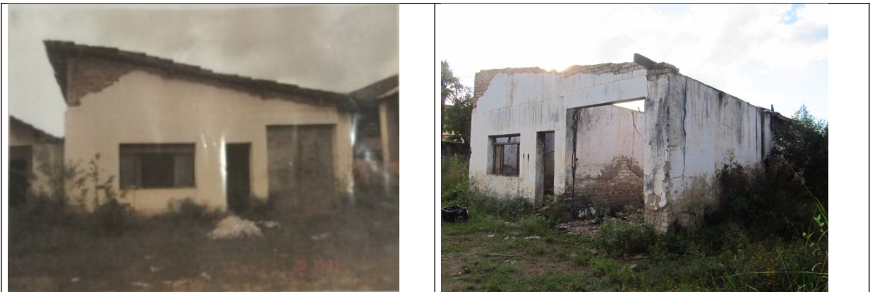
Figuras 18 e 19- Fonte: Dossiê de Tombamento da Cerâmica João Pinheiro e foto da vistoria.
