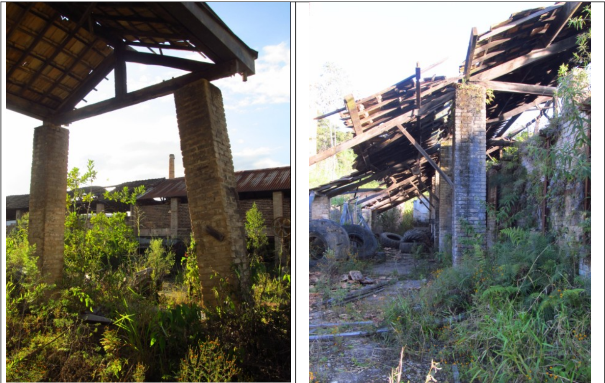
Figuras 42 e 43- Mau estado de conservação das edificações na Cerâmica João Pinheiro. Fotos da vistoria.
