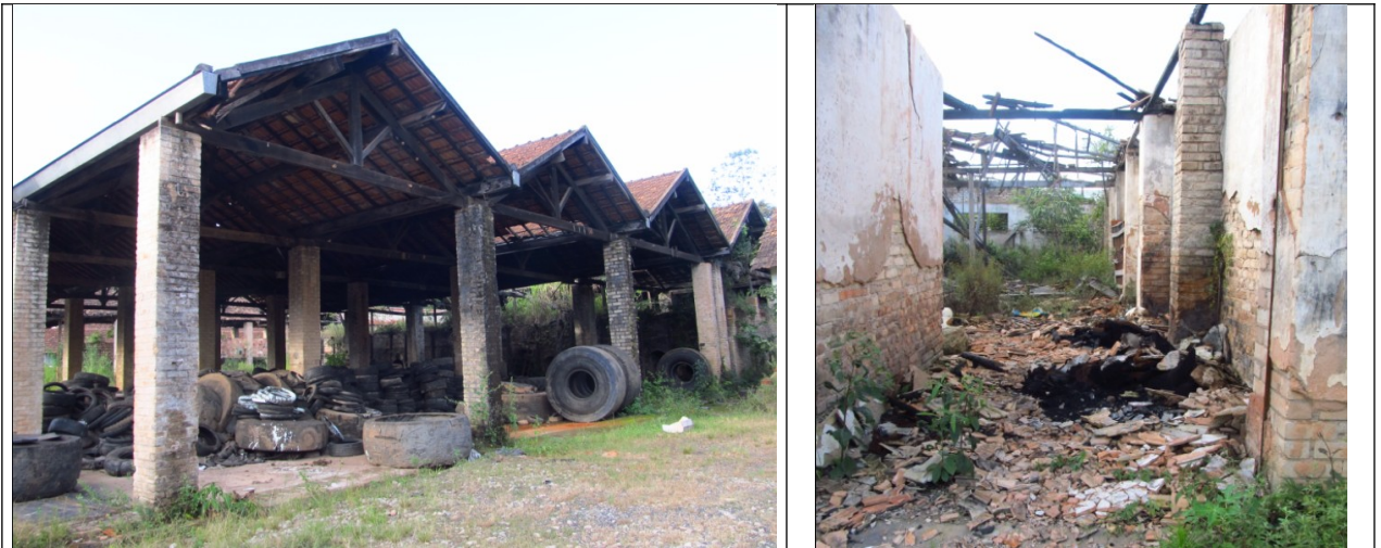
Figuras 38 e 39- Galpão utilizado como depósito de pneus e edificação recentemente incendiada na Cerâmica João Pinheiro. Fotos da vistoria.
