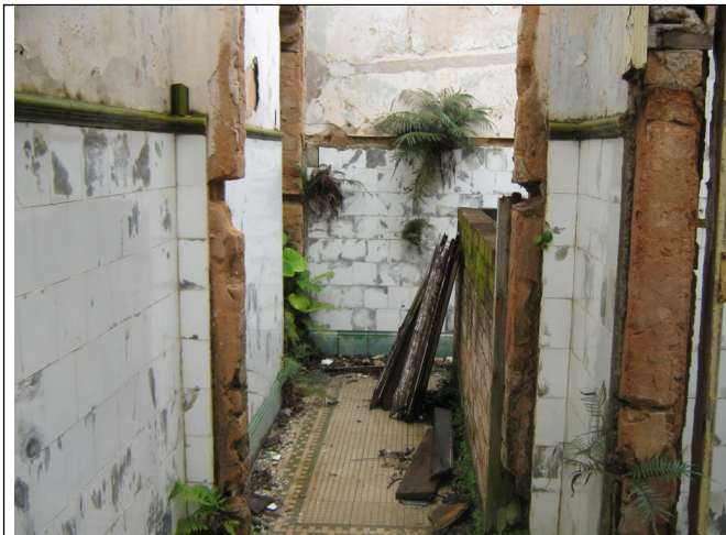
Figura 08 – Vestígios do piso de pastilhas e revestimento cerâmico das paredes.
