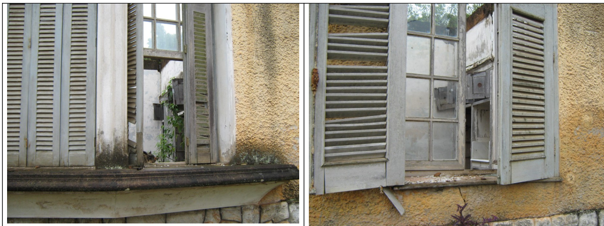
Figuras 13 e 14 – Esquadrias danificadas.
