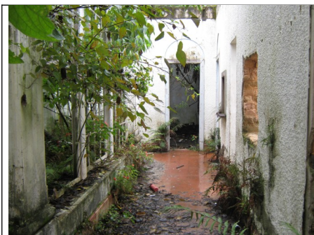
Figura 15 – Presença de umidade no interior do imóvel.
