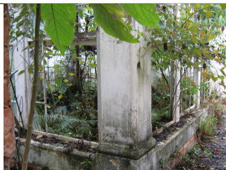
Figura 16 – Vegetação no interior do imóvel.
