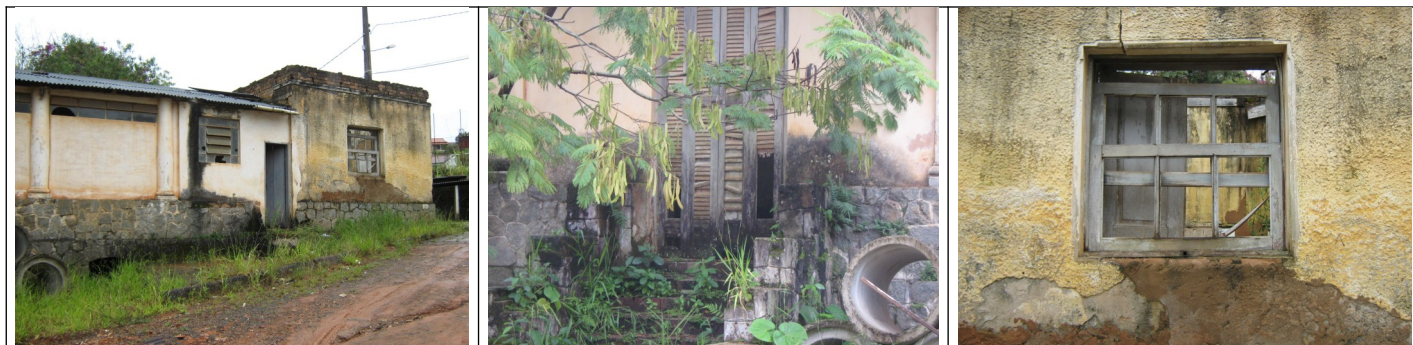
Figuras 10,11,12 – Alvenarias com umidade e esquadrias danificadas.
