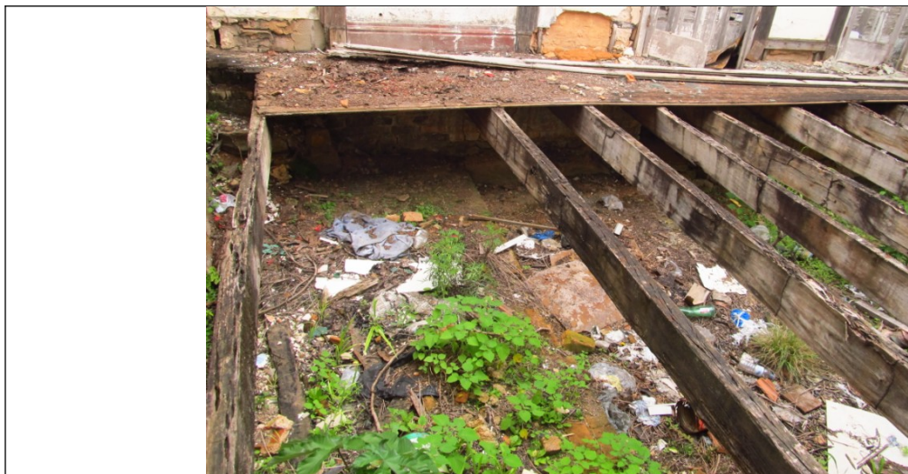
Figura 38 – Sujeira no interior do imóvel. Fonte: Vistoria realizada em 11/12/2012 pelo Setor Técnico desta Promotoria.
