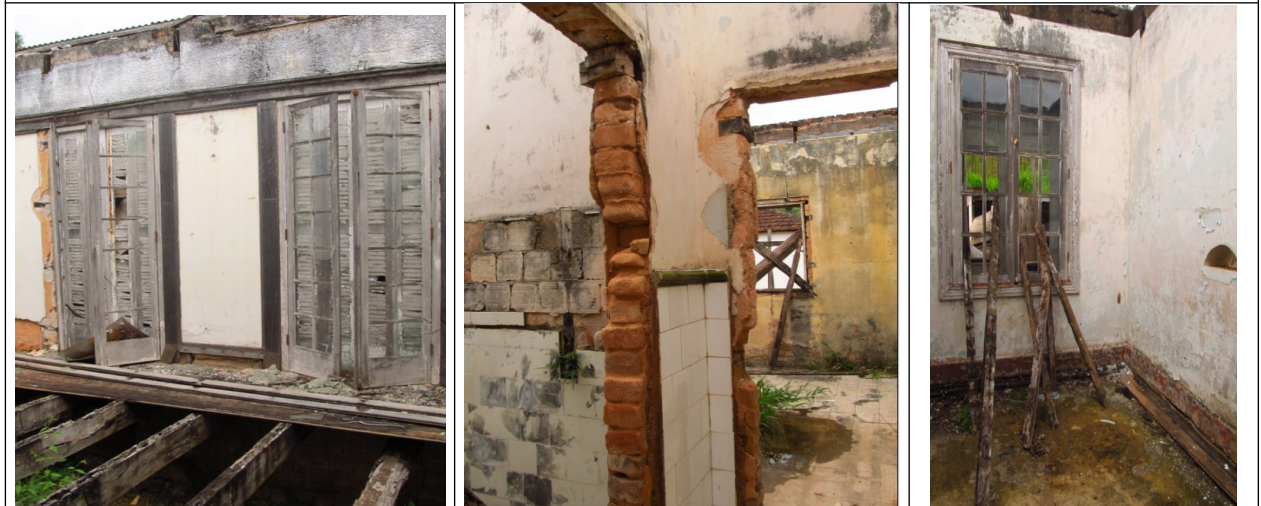
Figuras 22 a 24 – Esquadrias da Chácara das Rosas. Fonte: Vistoria realizada em 11/12/2012 pelo Setor Técnico desta Promotoria.
