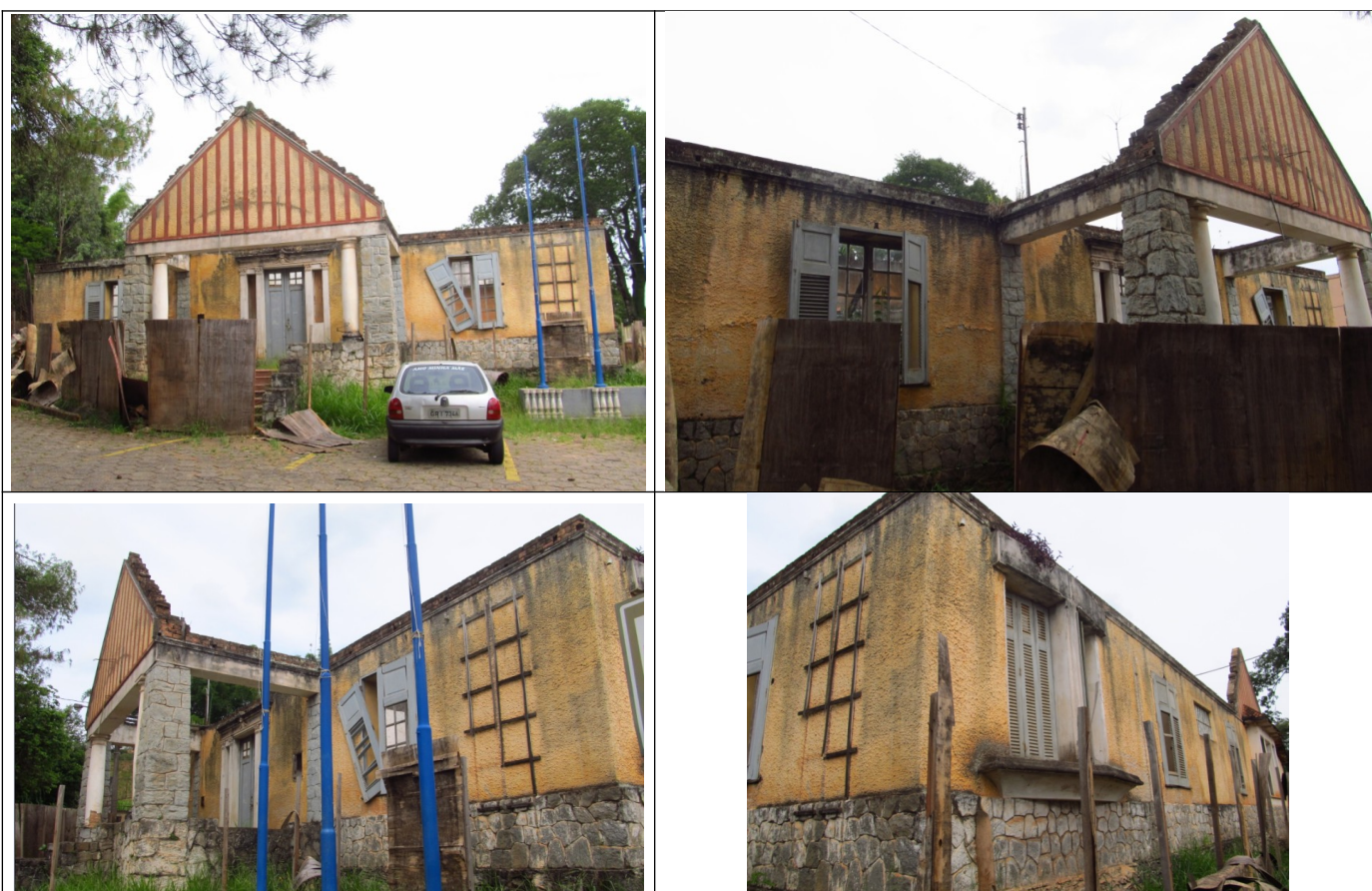
Figuras 15, 16, 17 e 18- Ausência de cobertura, tapume danificado, sujidades e manchas de umidade nas alvenarias. Fonte: Vistoria realizada em 11/12/2012 pelo Setor Técnico desta Promotoria.
