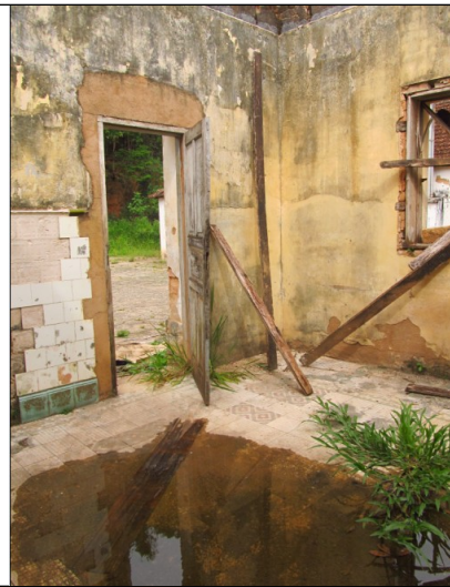
Figura 36 – Umidade no interior da edificação. Fonte: Vistoria realizada em 11/12/2012 pelo Setor Técnico desta Promotoria.
