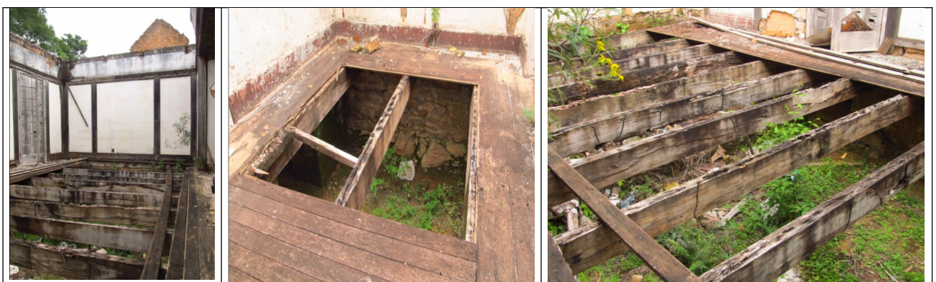
Figuras 25, 26 e 27 – Danos no piso de madeira e barrotes. Fonte: Vistoria realizada em 11/12/2012 pelo Setor Técnico desta Promotoria.
