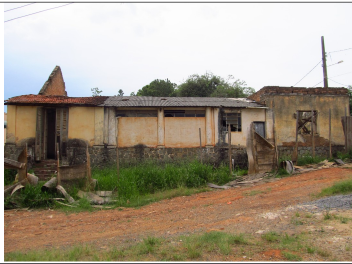
Figura 37 – Acréscimos nos fundos. Fonte: Vistoria realizada em 11/12/2012 pelo Setor Técnico desta Promotoria.
