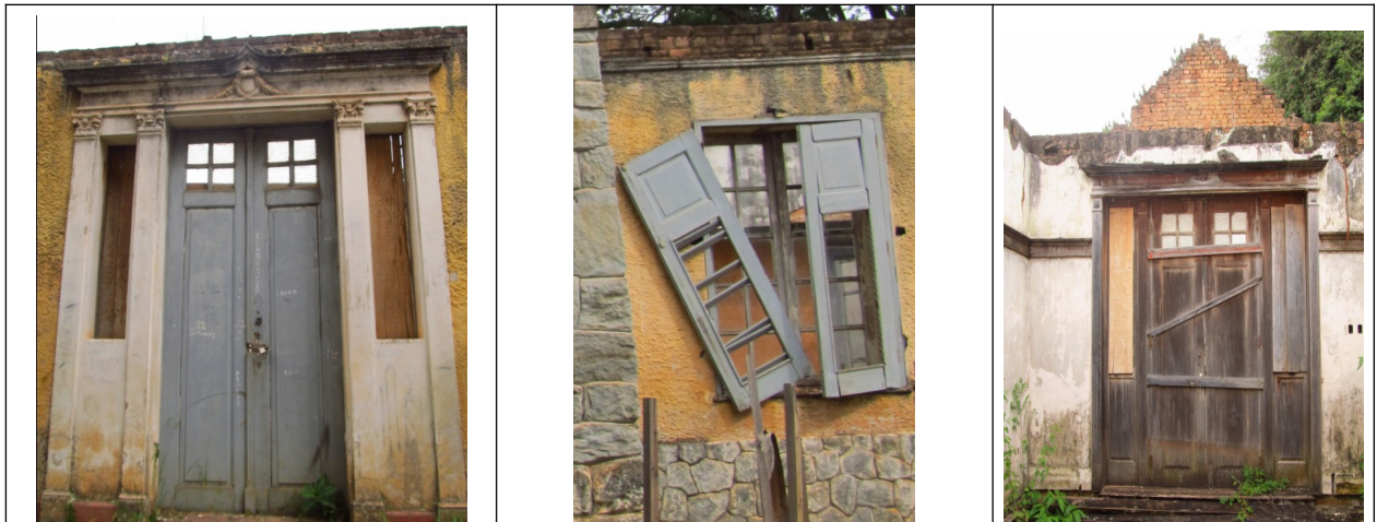
Figuras 19 a 21 – Esquadrias da Chácara das Rosas. Fonte: Vistoria realizada em 11/12/2012 pelo Setor Técnico desta Promotoria
