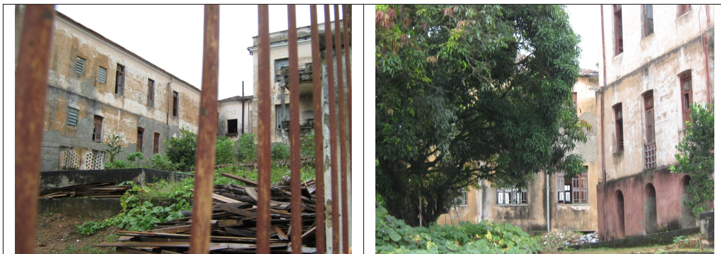
Figuras 18 e 19 – Presença de entulho e vegetação.
