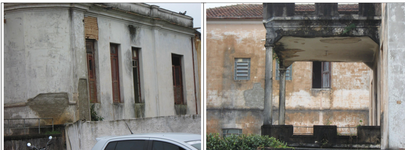
Figuras 15 e 16 – Patologias existentes nas alvenarias.
