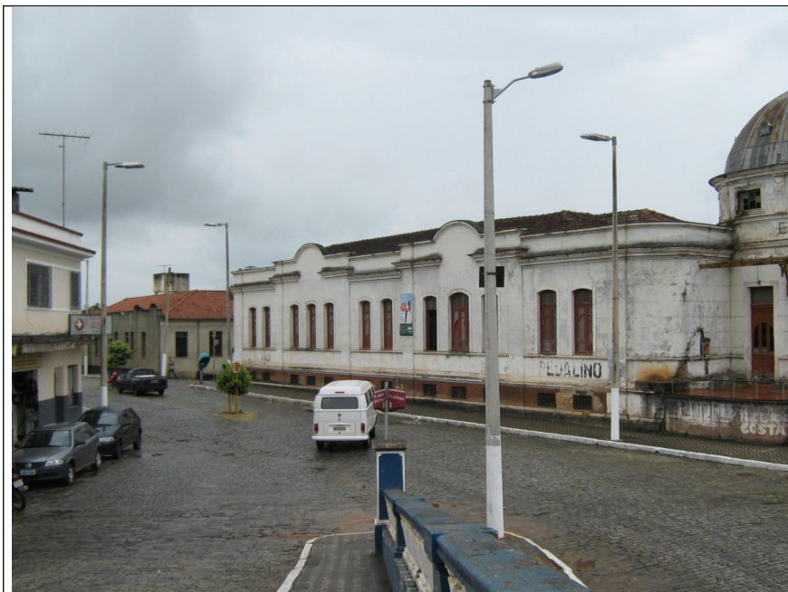
Figura 17 – Alvenaria com pichações e cartazes afixados.
