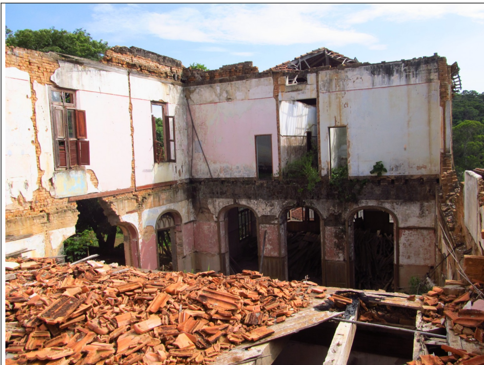
Figura 44– Imagem internas do trecho arruinado do Hotel Elite. Fonte: Vistoria 11 e 12 de dezembro de 2012 pelo Setor Técnico desta Promotoria.
