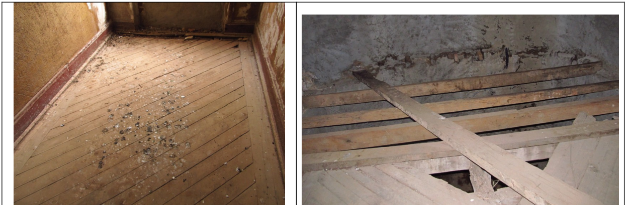
Figuras 36 e 37 – Pisos danificados no interior do Hotel Elite. Fonte: Vistoria 11 e 12 de dezembro de 2012 pelo Setor Técnico desta Promotoria.
