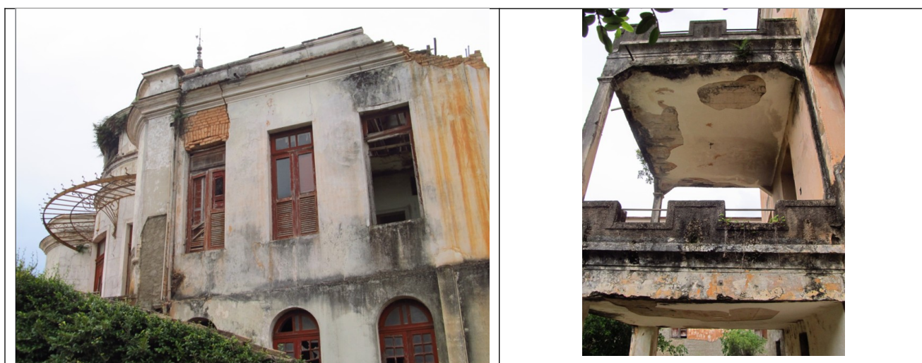
Figuras 30 e 31 – Patologias existentes nas alvenarias do Hotel Elite. Fonte: Vistoria 11 e 12 de dezembro de 2012 pelo Setor Técnico desta Promotoria.
