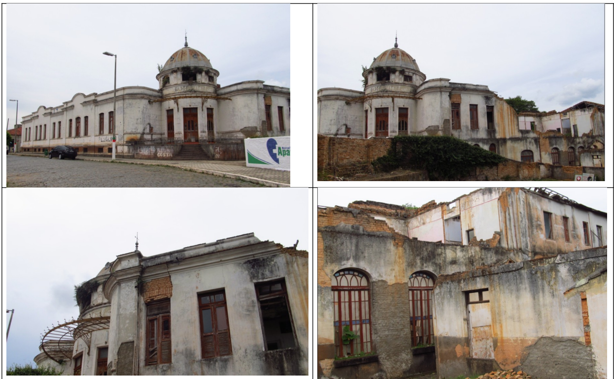
Figuras 17, 18, 19 e 20- Imagens externas do Hotel Elite, evidenciando o processo de arruinamento da edificação. Fonte: Vistoria 11 e 12 de dezembro de 2012 pelo Setor Técnico desta Promotoria.
