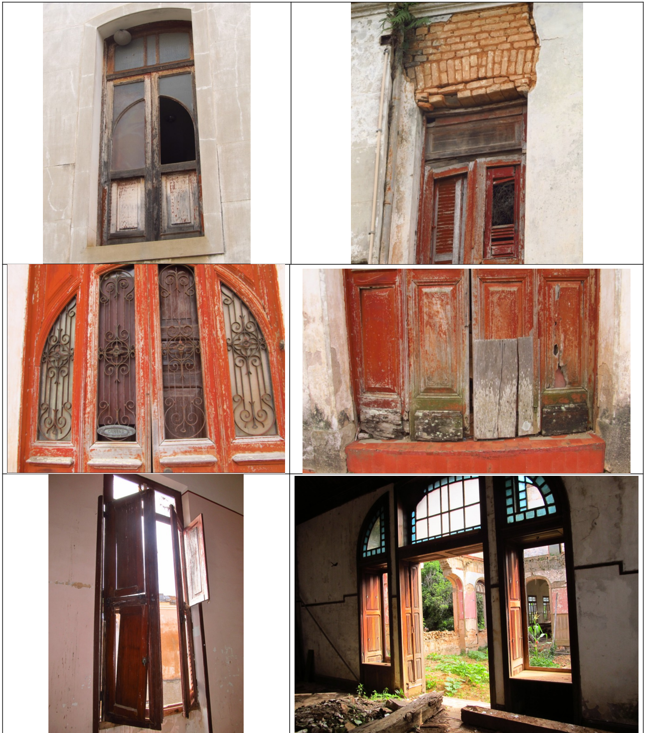
Figuras 21, 22, 23, 24, 25 e 26 – Alguns exemplos de esquadrias. Fonte: Vistoria 11 e 12 de dezembro de 2012 pelo Setor Técnico desta Promotoria.
