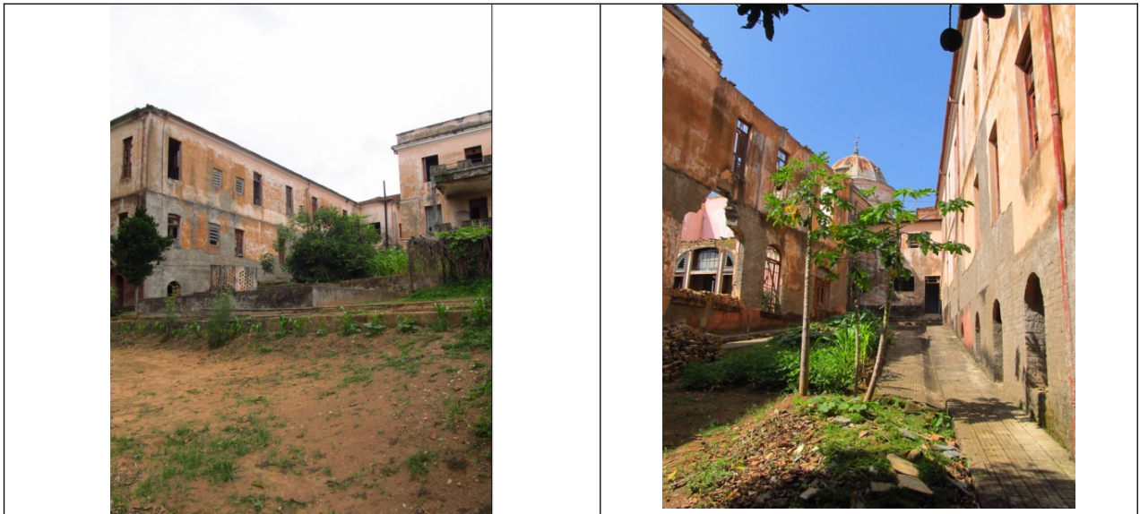
Figuras 32 e 33 – Fundos do Hotel Elite. Fonte: Vistoria 11 e 12 de dezembro de 2012 pelo Setor Técnico desta Promotoria.
