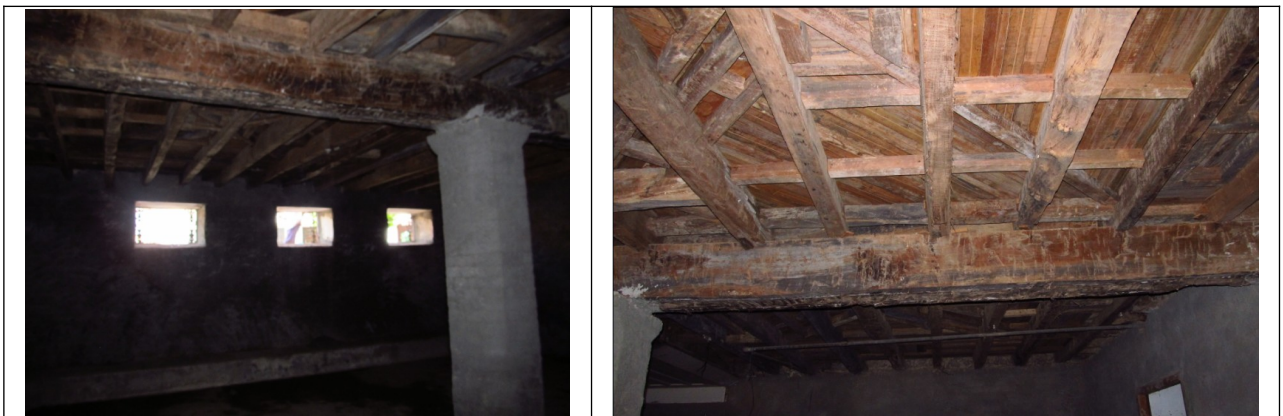
Figuras 38 e 39 – Estrutura do piso de madeira. Fonte: Vistoria 11 e 12 de dezembro de 2012 pelo Setor Técnico desta Promotoria.
