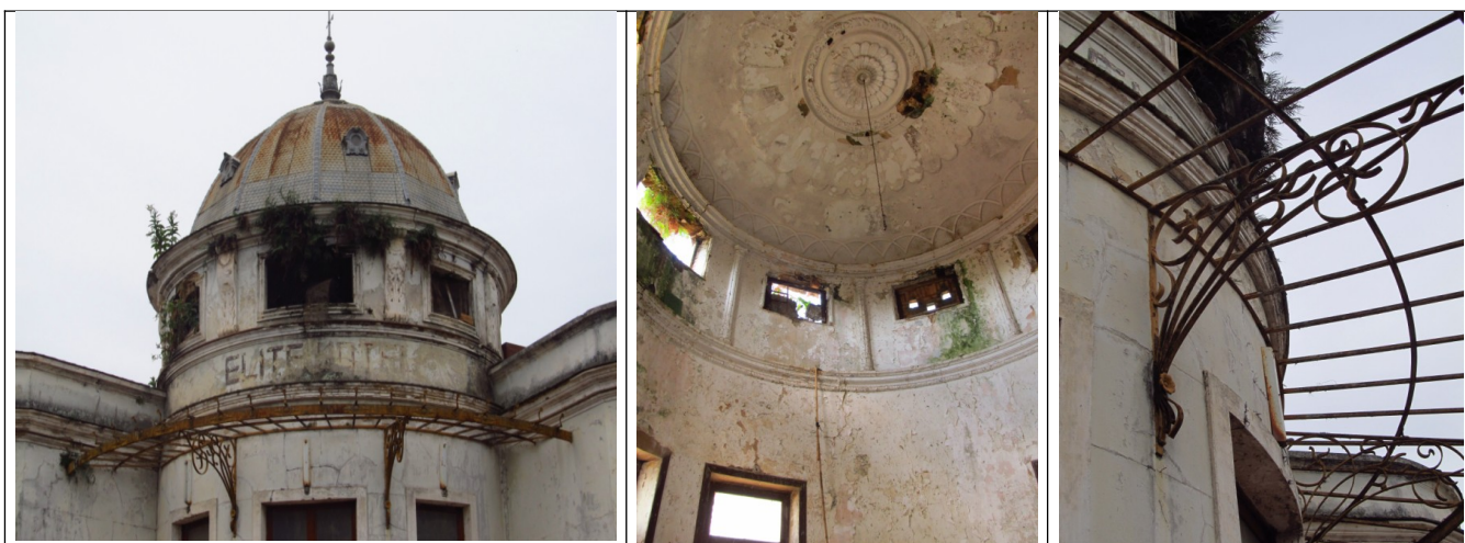
Figuras 27, 28 e 29 – Cúpula e cobertura do acesso principal do Hotel Elite. Fonte: Vistoria 11 e 12 de dezembro de 2012 pelo Setor Técnico desta Promotoria.
