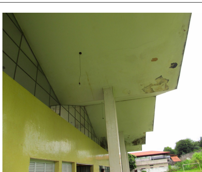
Figura 15 – Detalhe das instalações elétricas e da laje.
