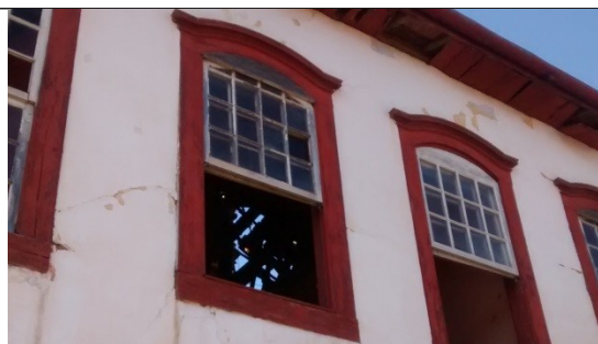
Figura 9 – Detalhe da vista do telhado pela janela da fachada frontal. Nota-se as telhas faltantes.
