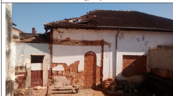
Figura 12 – Vista posterior. Nota-se parte arruinada da cobertura.
