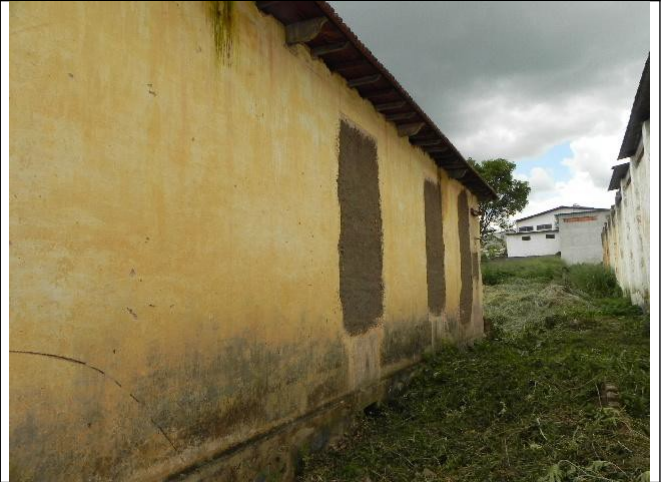
Figura 11 – Manchas de umidade.
