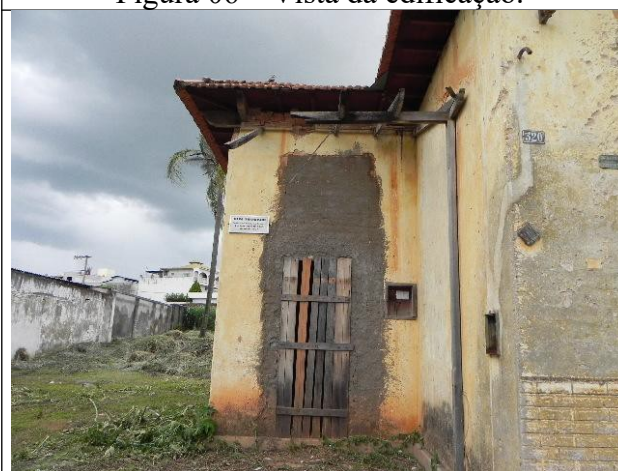
Figura 08 – Cobertura da varanda danificada.
