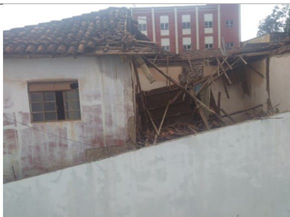
Figura 2 – Vista lateral do imóvel, com detalhe do arruinamento parcial da cobertura e de alvenaria.
