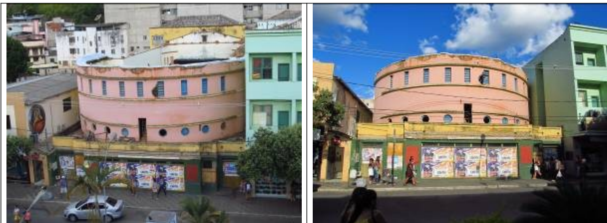
Figuras 08 e 09 -Cine Brasil: ausência de cobertura e tapumes na entrada principal Fotos da vistoria realizada em 21.01.2015.
