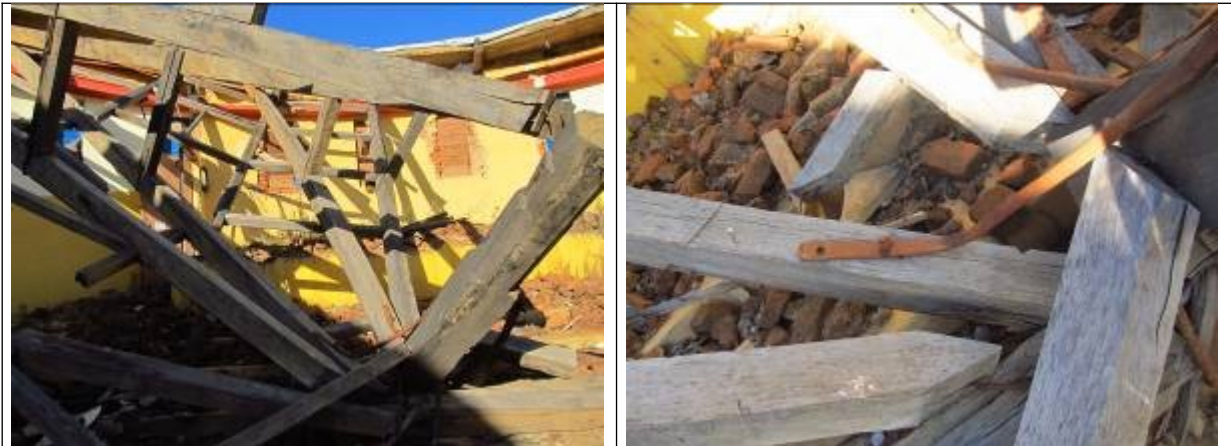
Figuras 16, 17, 18 e 19- Cobertura desabada na parte superior do antigo cinema. Fotos da vistoria realizada em 21.01.2015.
