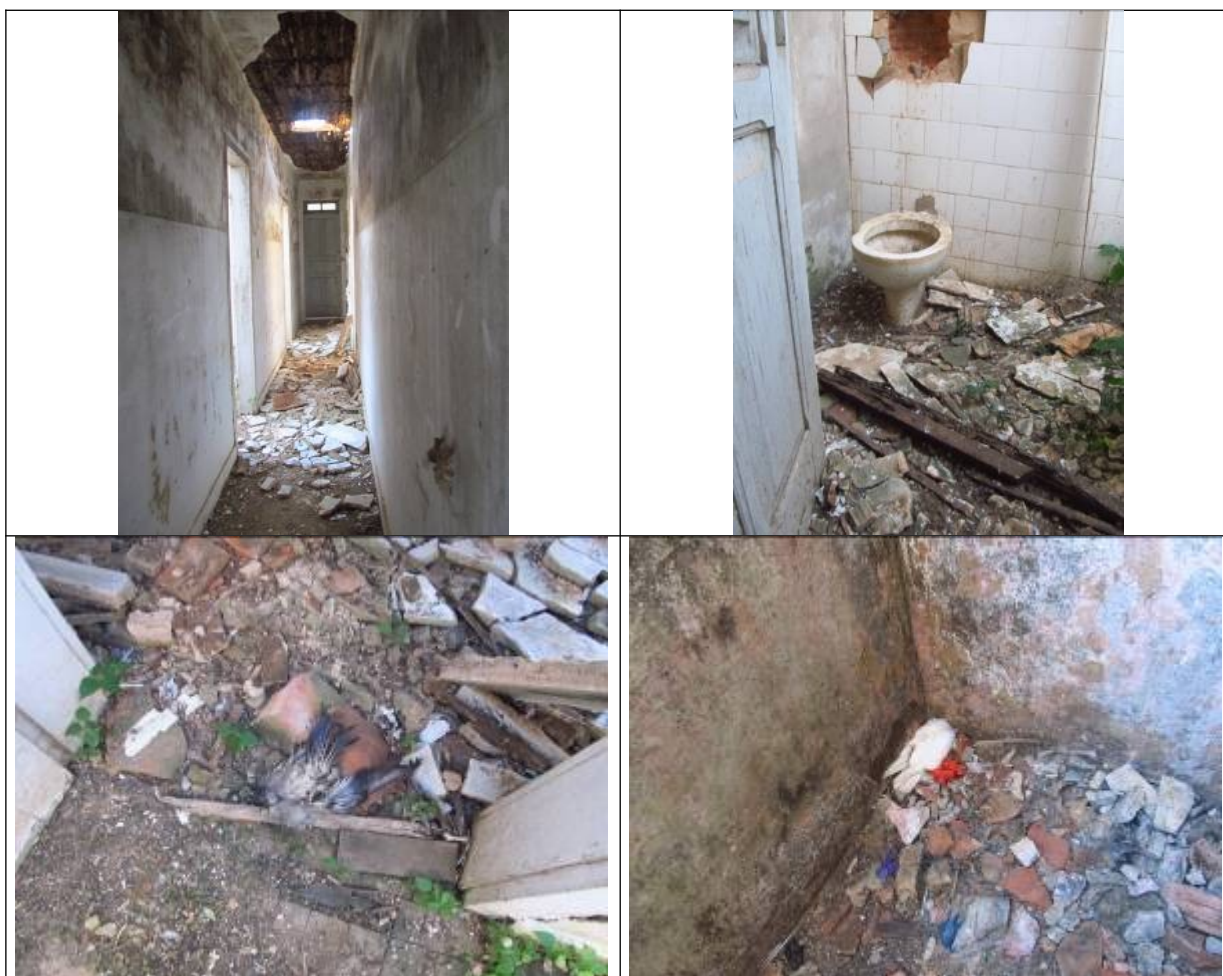
Figuras 26, 27, 28, 29, 30 e 31- Imagens internas do anexo existente ao Cine Brasil. Fotos da vistoria realizada em 21.01.2015.
