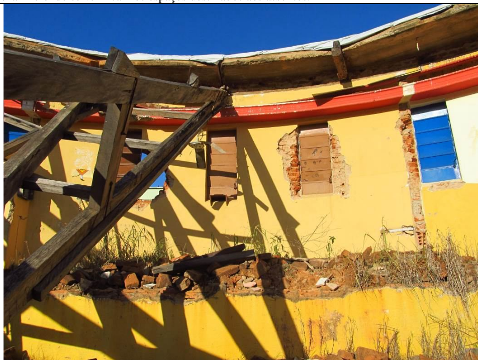
Foto 11- Detalhe do mezanino sem a cobertura.
