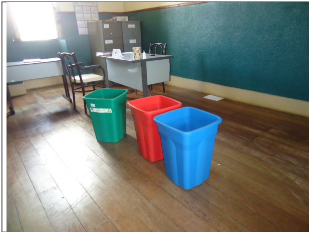
Figura 24 – Baldes posicionados para conter a umidade no cômodo da secretaria, que se encontra interditado.
