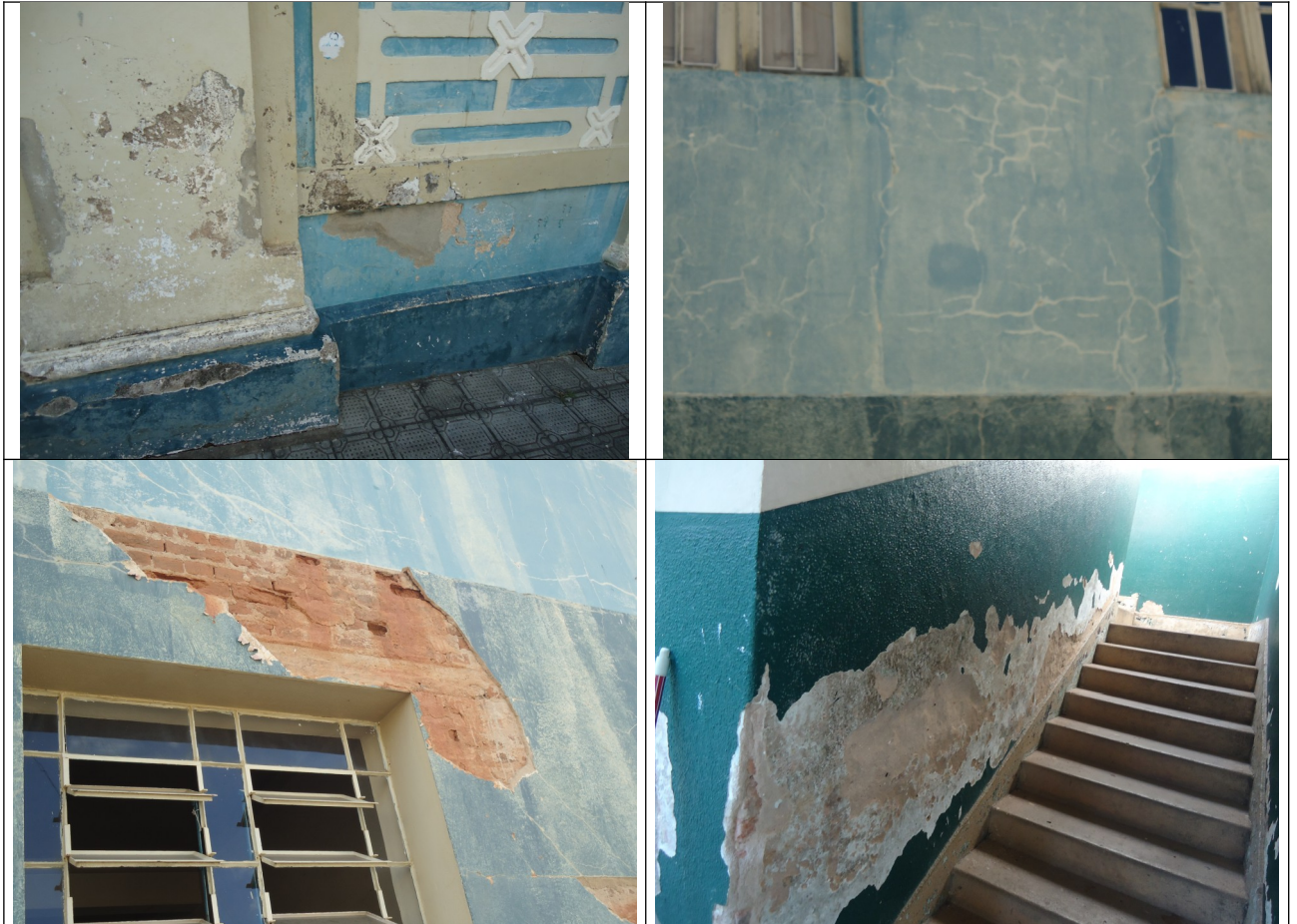
Figuras 04 a 07 – Manchas de umidade, fissuras e descolamento do reboco.
