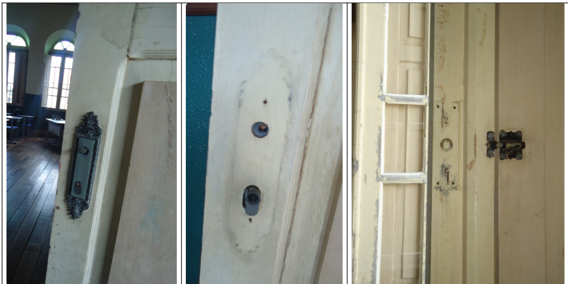
Figuras 11 a 13 – Ausência de ferragens nas esquadrias: maçanetas e cremonas.
