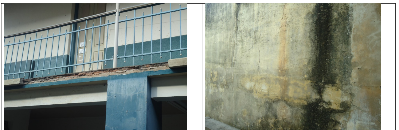
Figuras 08 e 09 – Ornamentos em massa em processo de desprendimento e manchas de umidade no muro lateral.
