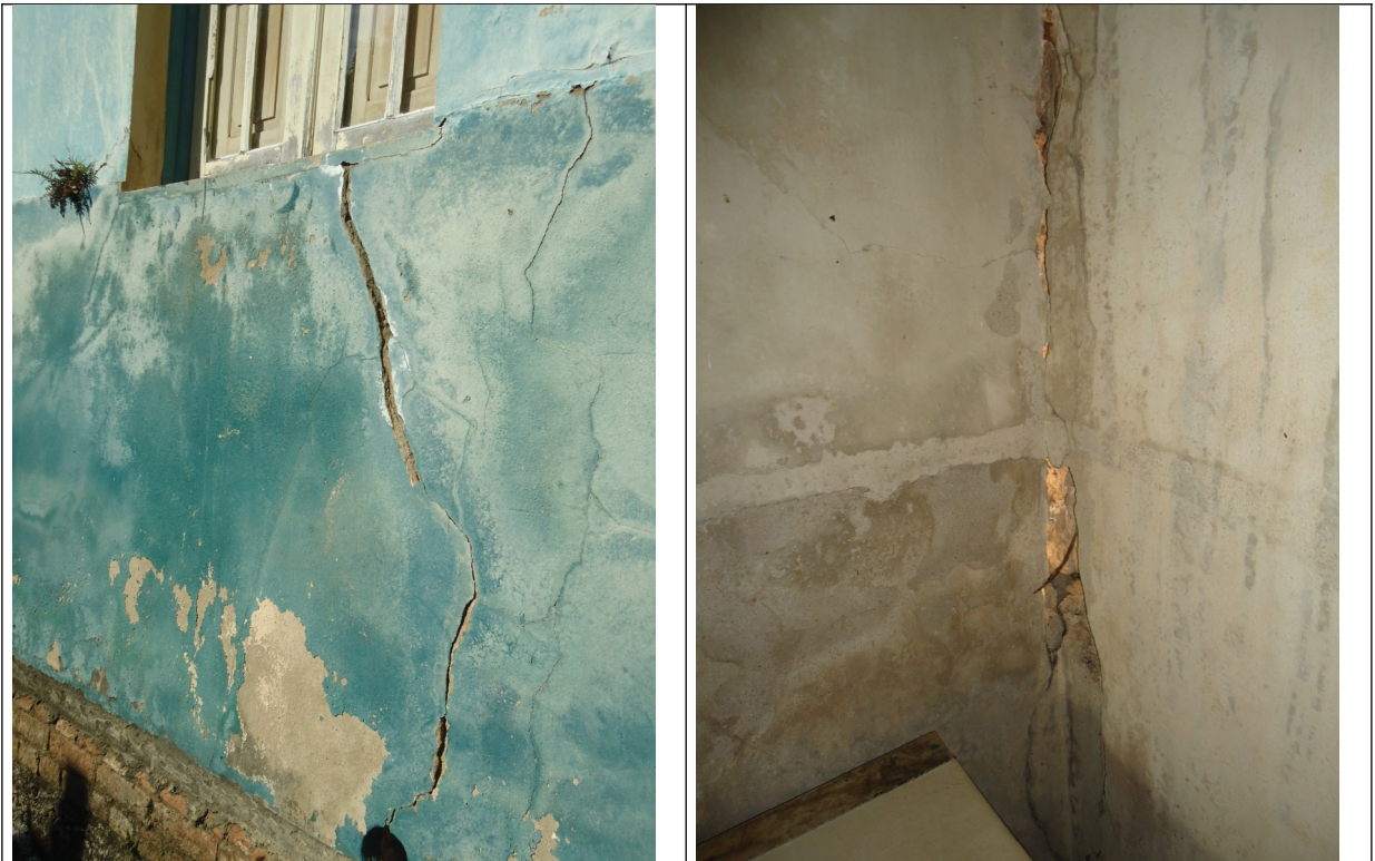
Figuras 09 e 10 – Grande trinca na alvenaria da sala de aula que foi interditada e trinca existente na junção dos muros divisórios.
