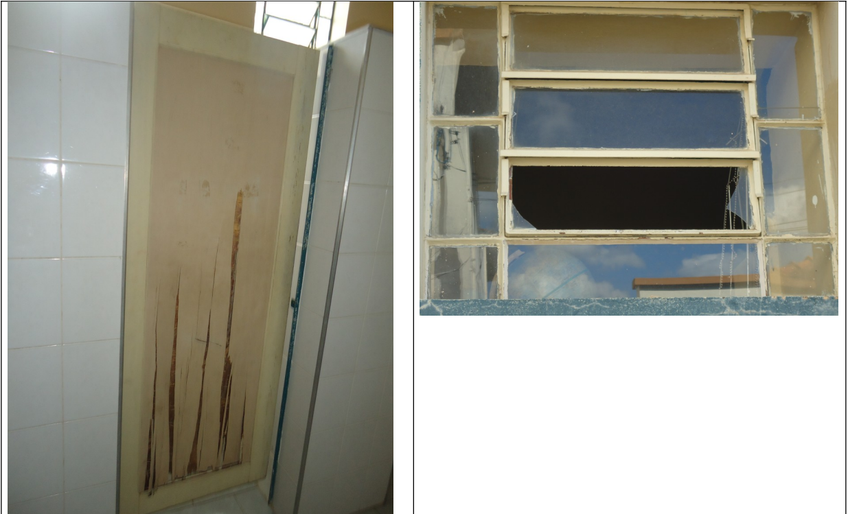
Figuras 14 e 15 – Porta de madeira danificada no banheiro e vidro quebrado na esquadria metálica.
