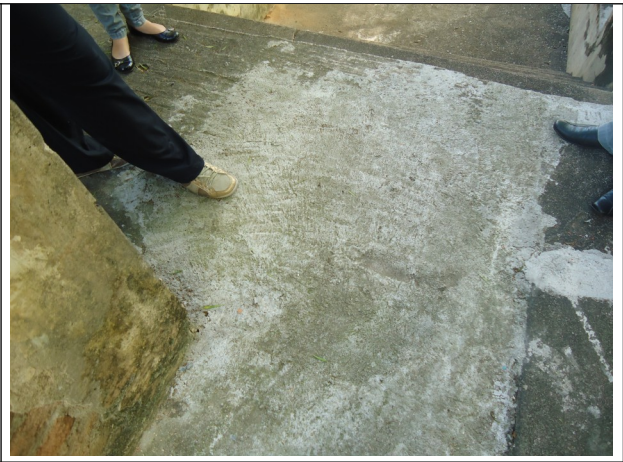
Figura 25 – Impermeabilização realizada na área externa, sem acompanhamento técnico adequado.
