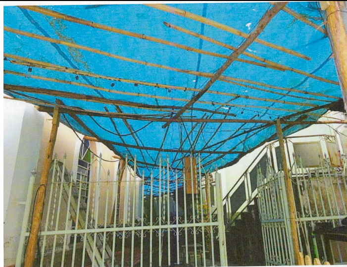
Figura 12 – Imagem das estruturas improvisadas utilizada no espaço, durante festa da Padroeira realizada no ano de 2010. Imagem integrante dos autos.
