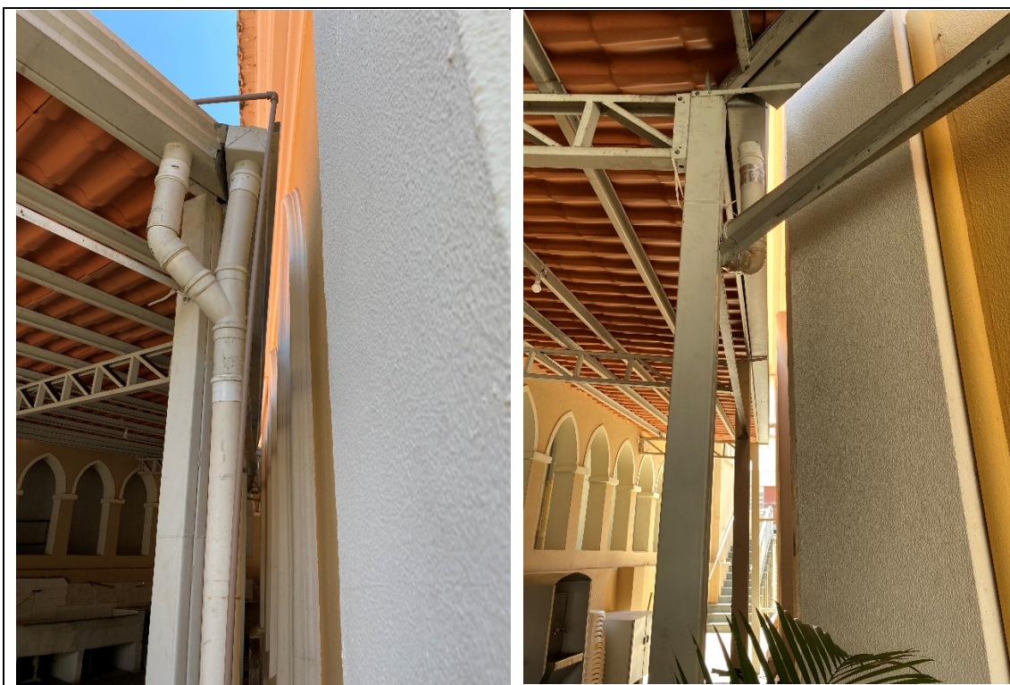
Figuras 03 e 04 – Proximidade da estrutura da alvenaria dos fundos da igreja matriz.
