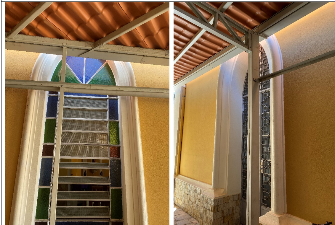
Figuras 05 e 06 – Obstrução de janela e porta existentes nos fundos da igreja, prejudicando a ventilação e insolação.
