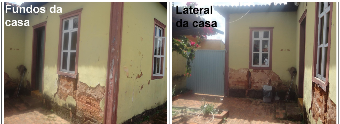
Figuras 21 e 22 – Descolamento de reboco.
