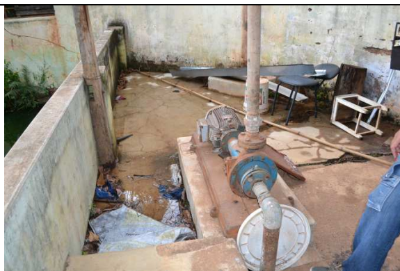
Figura 09 – Presença de bomba e outros objetos na área interna do reservatório.
