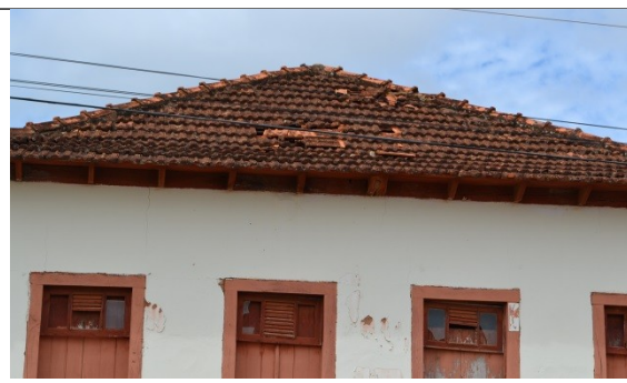
Figura 07 – Telhas deslocadas e vidros quebrados.
