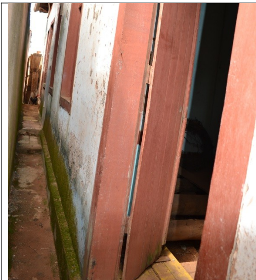
Figura 10 – Proximidade da edificação vizinha e manchas de umidade junto a base.
