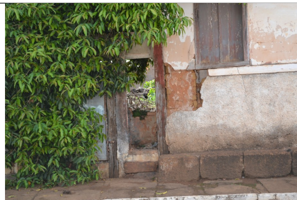
Figura 08 – Danos nas alvenarias.
