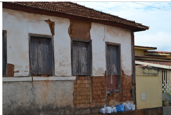
Figura 09 – Descolamento do reboco e trincas na fachada.
