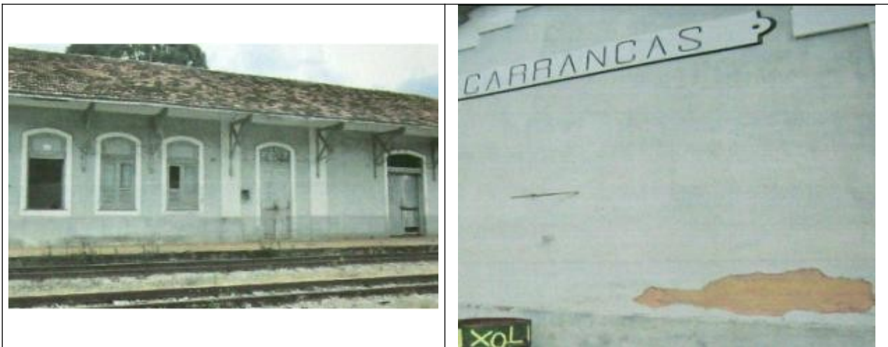
Figuras 06 e 07 – Fotografias inseridas na ficha de inventário da Estação de Carrancas. Observa-se nos registros que uma das janelas está quebrada e que o reboco externo da estação caiu.
