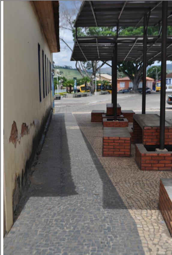
Figura 11 – Imagem da cobertura e do mobiliário fixo existente, bastante próximo de uma edificação residencial, que apresenta manchas de umidade e descolamento do reboco junto à base.
