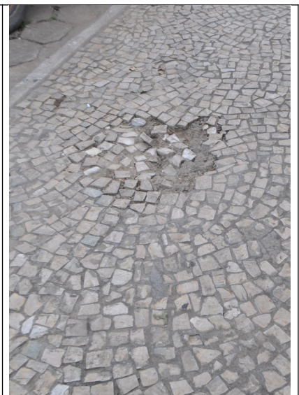
Figura 15 – Calçamento em pedras portuguesas danificado.
