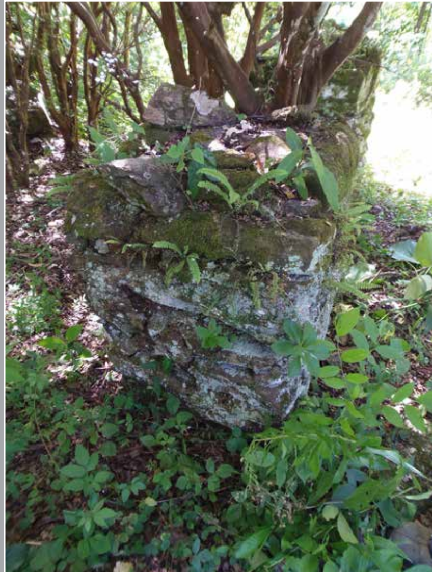
Foto 39- Os muros estão cedendo com o crescimento gradativo de árvores de porte rente a eles. Foto: Henrique Piló, 2014.
