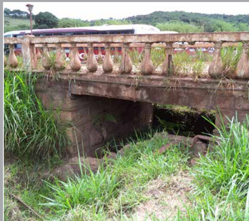
Foto 24 - Ponte ferroviária com balaustrada em ruínas. Foto: Henrique Piló, 2014.
