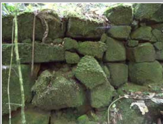
Foto 19 – Detalhe do sistema construtivo com peças apoiadas umas sobre as outras, sem rejunte argamassado. Foto: Henrique Piló, 2014.
