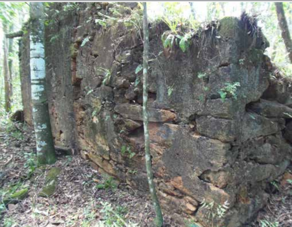
Foto 50 – Fachada posterior onde podem ser observados vestígios do revestimento. Foto: Henrique Piló, 2014.
