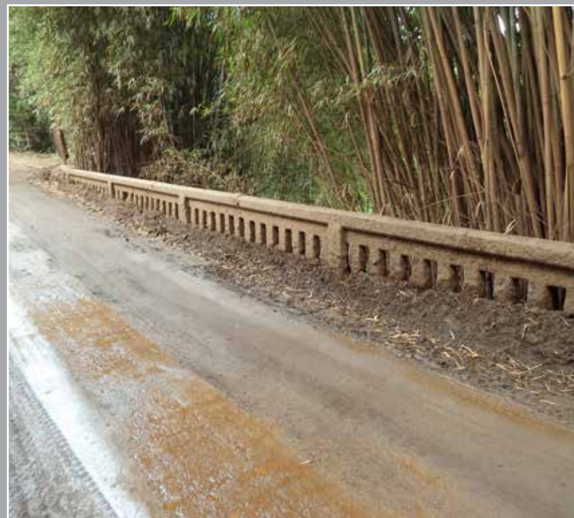
Foto 23 – O acúmulo de minério já obstruindo os vazios da balaustrada. Foto: Henrique Piló, 2014.
