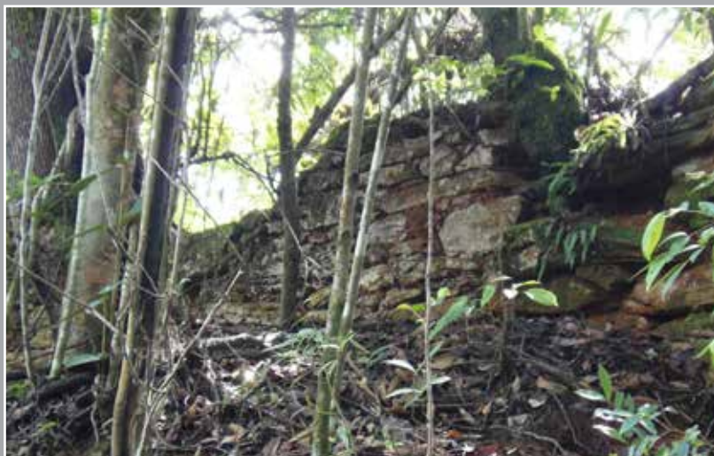
Foto 28 – Vista parcial de um pano de alvenaria com possíveis indícios de um vão de janela. Foto: Henrique Piló, 2014.
