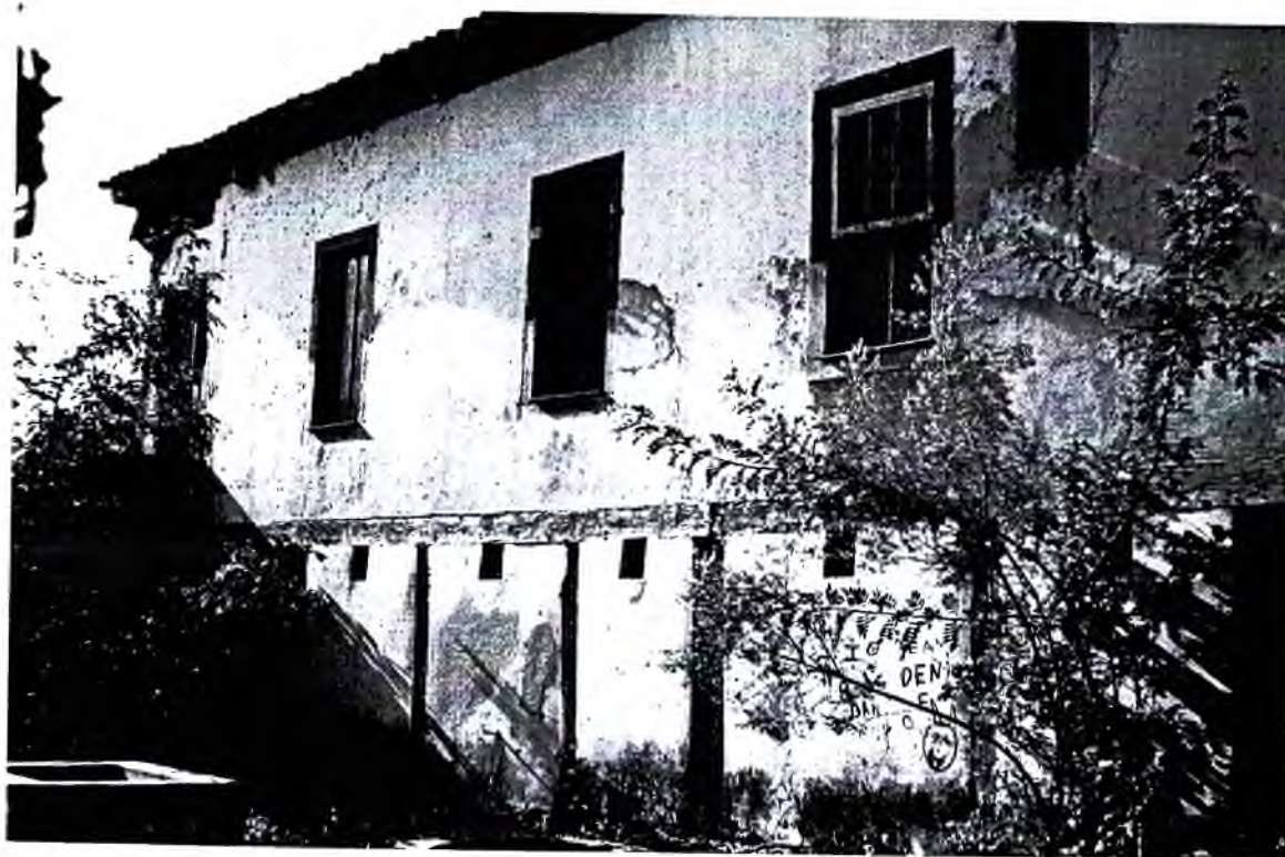
F 15 - Fachada Posterior. Observar perda das folhas de guilhotina das janelas.
