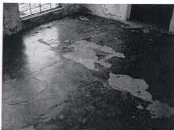
Rachaduras e trincas no piso do alpendre de acesso.
