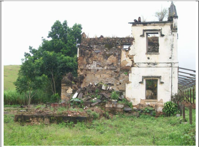
Figura 13 – Torreão esquerdo em processo de arruinamento.
