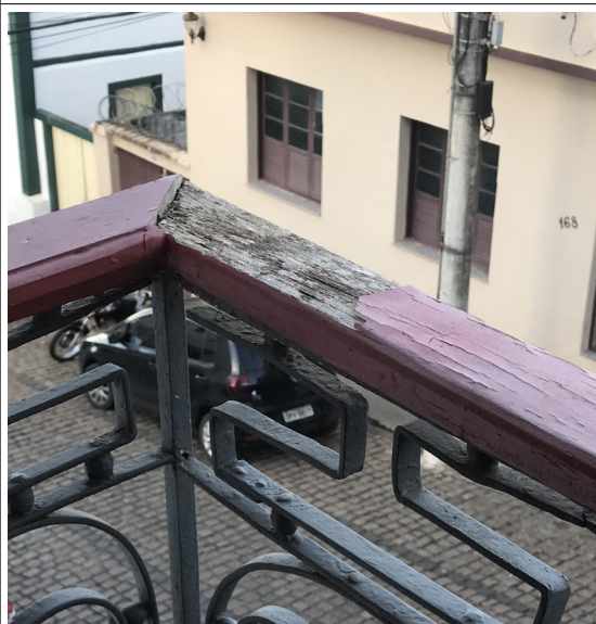
Figura 08 - Lacuna no guarda corpo de madeira.
