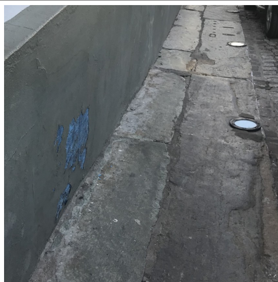
Figura 05 - Descolamento de pintura na base da edificação.
