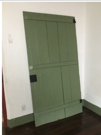
Figura 06 - Porta que foi removida devido ao comprometimento das ferragens.
