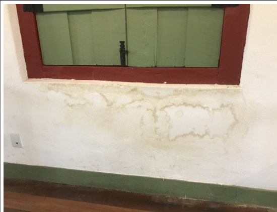
Figura 10 - Manchas de umidade próximo as alvenarias .
