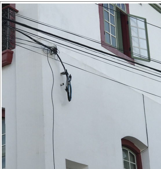
Figura 12 - Fiação exposta na fachada.
