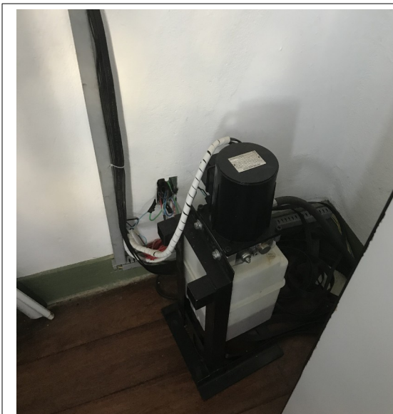
Figura 11 - Equipamento sem proteção e com fiação exposta.
