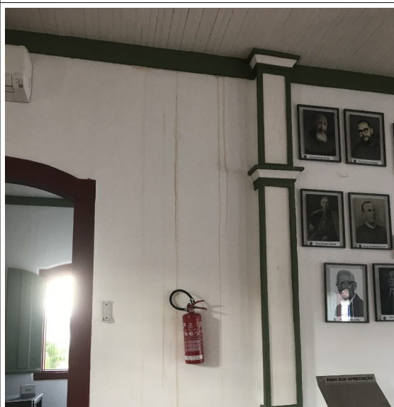
Figura 07 - Mancha de umidade nas alvenarias.
