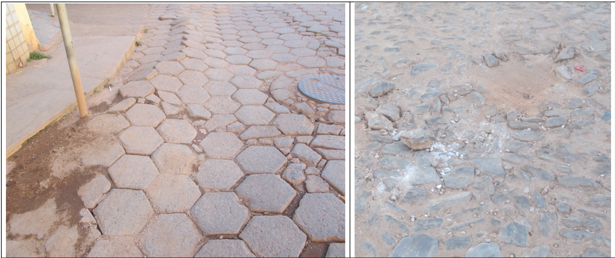
Figuras 15 e 16- Pavimentação danificada. Foto da vistoria.
