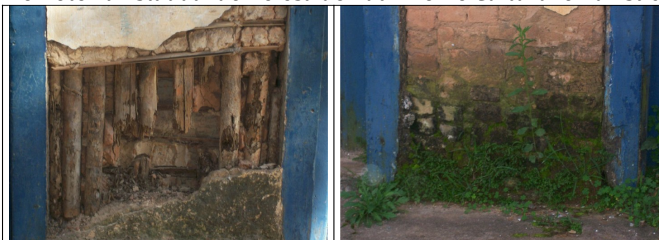
Figura 08 – Madeira da trama de pau a pique apodrecida.
