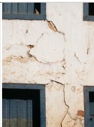
Figura 12 – Trincas e rachaduras na alvenaria externa.
