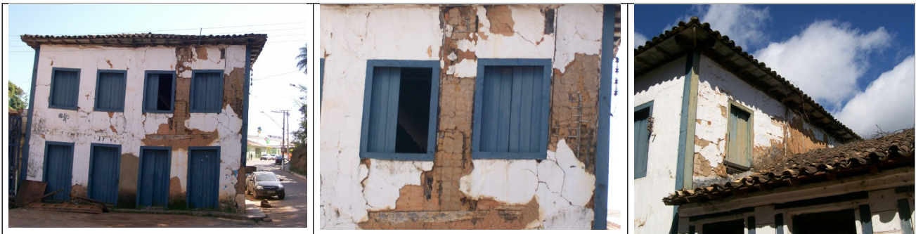
Figuras 05, 06 e 07 – Vista do imóvel com trechos com desprendimento de reboco.
