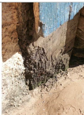
Figura 13 – Pé de esteio deteriorado.
