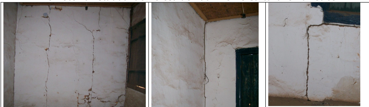
Figuras 18, 19 e 20 – Trincas nas alvenarias do segundo pavimento.
