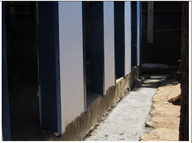
Figura 14 – Desnível no acesso à edificação.
