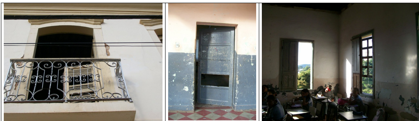
Figuras 18 a 20 – Esquadrias danificadas ou faltantes.
