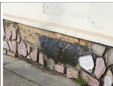
Figura 07 – Barrado de pedras descaracterizante com pedras soltas.
