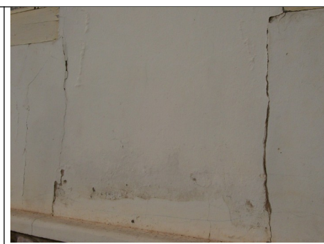
Figura 08 – Trincas e fissuras.
