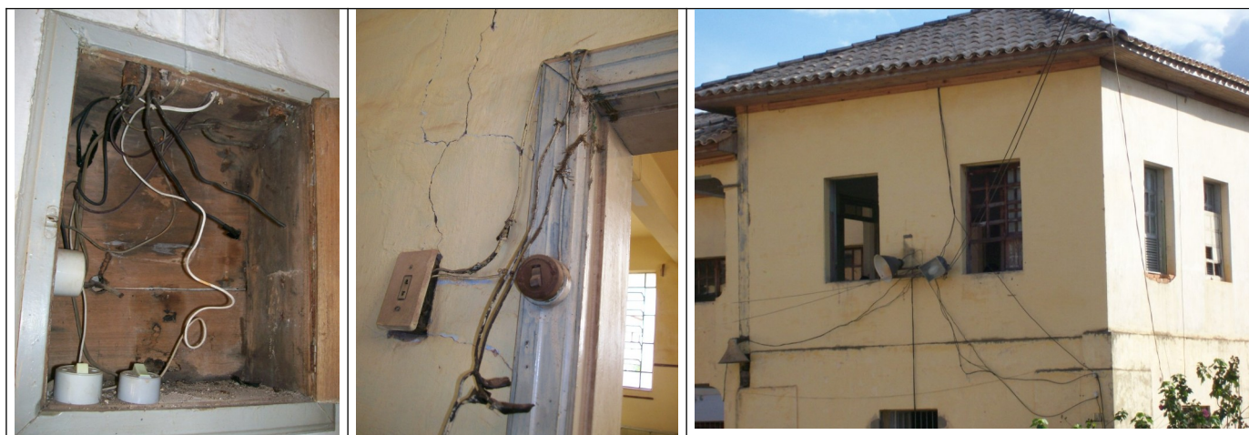
Figuras 23 a 25 – Precárias instalações elétricas.
