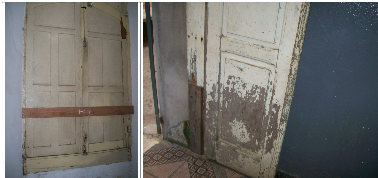
Figuras 21 e 22 – Esquadrias danificadas.
