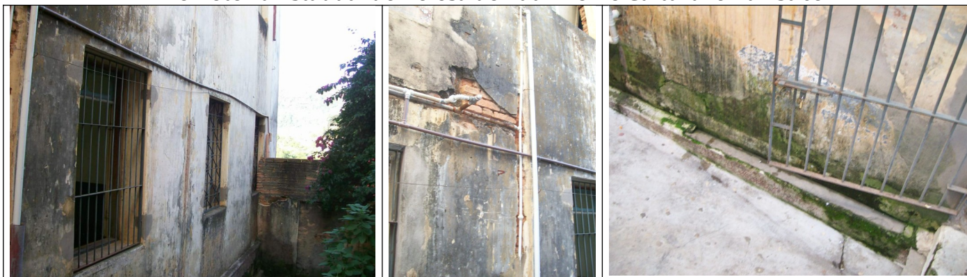
Figuras 12 e 13 – Presença de umidade nas alvenarias e grades nos vãos, descolamento do reboco e instalações hidráulicas externas às alvenarias.
