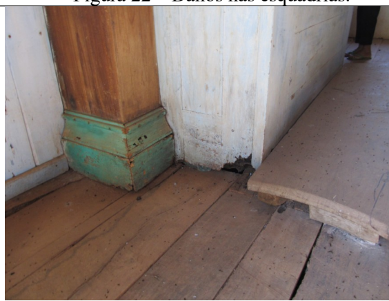
Figura 24 – Patologias nos elementos de madeira.
