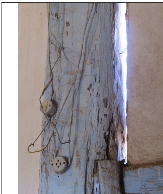
Figura 21 – Instalações elétricas precárias.
