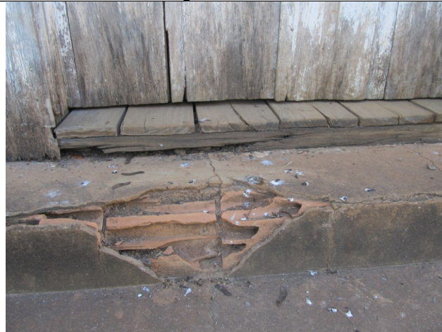
Figura 17 – Inserção de materiais contemporâneos, já danificados.
