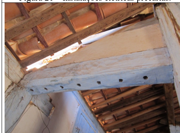
Figura 23 – Ausência de vedação na cobertura.
