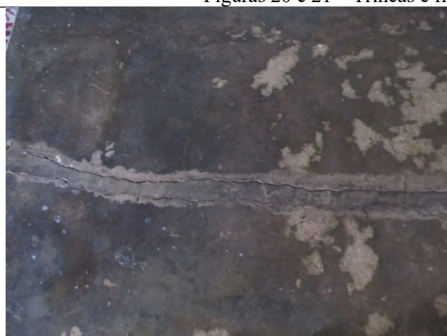
Figura 22 – Emenda no piso cimentado.
