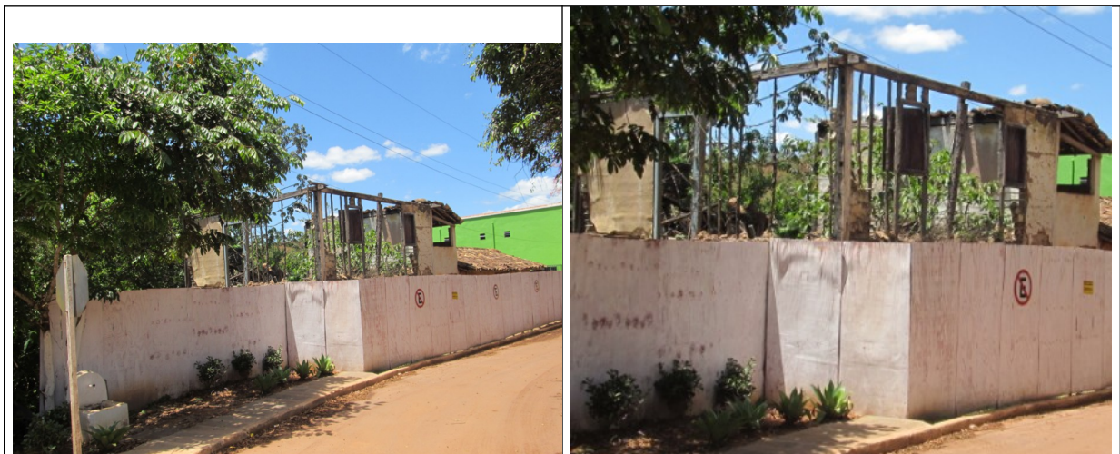
Figuras 30 e 31 – Edificação em ruínas no entorno da Capela de São Sebastião do Bom Sucesso.
