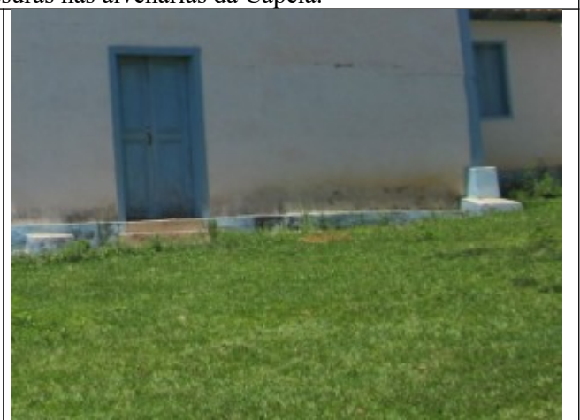
Figura 23 – Manchas de umidade junto à base.
