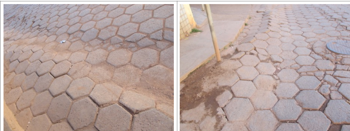
Figuras 28 e 29- Pavimentação predominante no Núcleo Histórico de Conceição do Mato Dentro, apresentando ondulações e peças quebradas. Fotos da vistoria.
