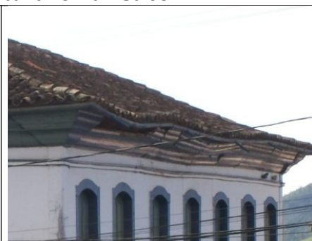
Figura 13 – Ondulações na cobertura.
