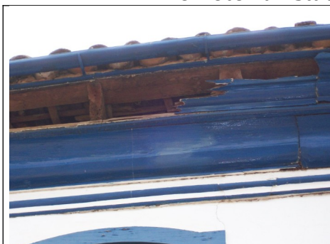
Figura 11 – Trecho faltante na cimalha.
