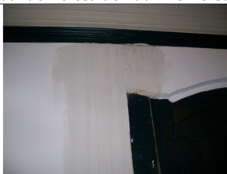
Figura 12 – Presença de umidade nas alvenarias internas.
