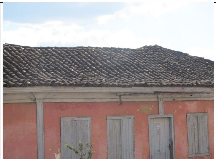
Figura 17 – Abatimento da cobertura.
