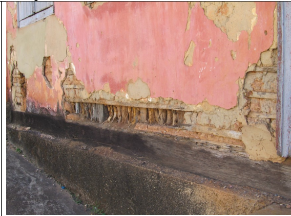
Figura 15 – Desprendimento do reboco e intervenções em argamassa de cimento.
