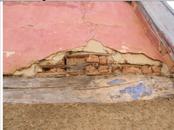
Figura 14 – Desprendimento do reboco.
