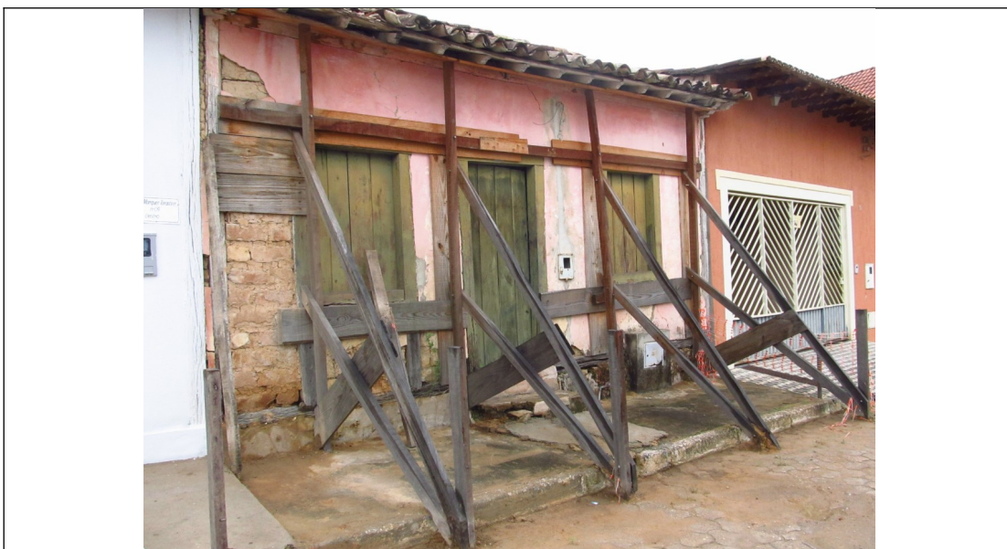
Figura 08 – Imagem de escoramento de fachadas. Fonte: Setor Técnico Promotoria Estadual de Defesa do patrimônio Cultural e Turístico de MG.
