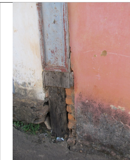
Figura 16 – Perda de elementos
