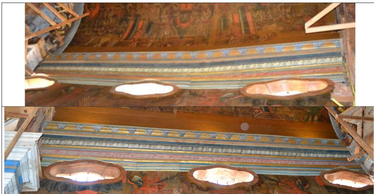
Figuras 13 e 14 – Nos registros fotográficos verifica-se finalização do trabalho de restauração das cimalhas do forro.
