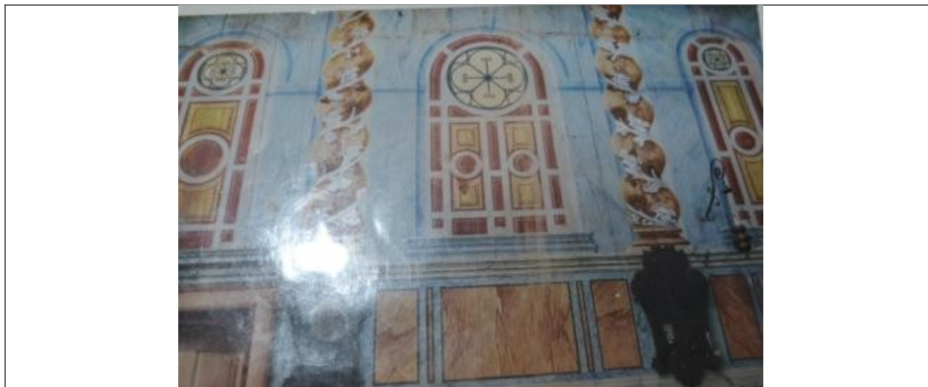
Figura 17 – Aspecto geral de uma das paredes da capela mor, ainda com repintura da década de 1930. Fonte: Cantaria Conservação e Restauração.
