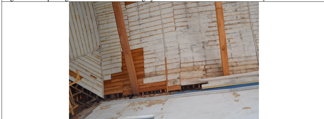
Figura 55 – Detalhe do forro da nave que precisa de reparos quanto ao seu pleno fechamento.
