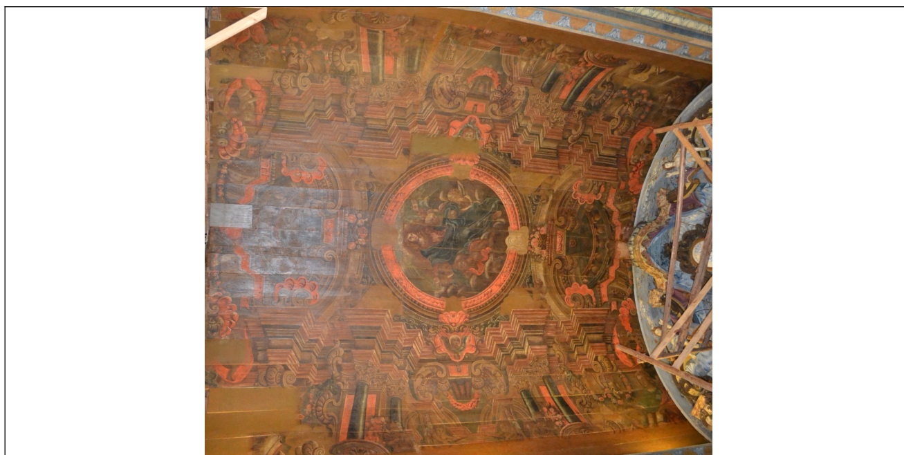
Figura 07 – No registro fotográfico verifica-se o trabalho de restauro realizado no forro da capela mor.
