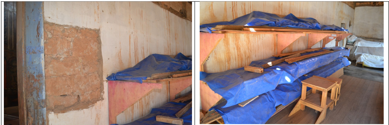
Figuras 63 e 64 – Nota-se as manchas na parede da sacristia da lateral direita do templo. Essas manchas (amarelas alaranjadas), na vertical, coincidem com as áreas em que as telhas estão afastadas da alvenaria. Indícios de que está ocorrendo a entrada de água por esta passagem.
