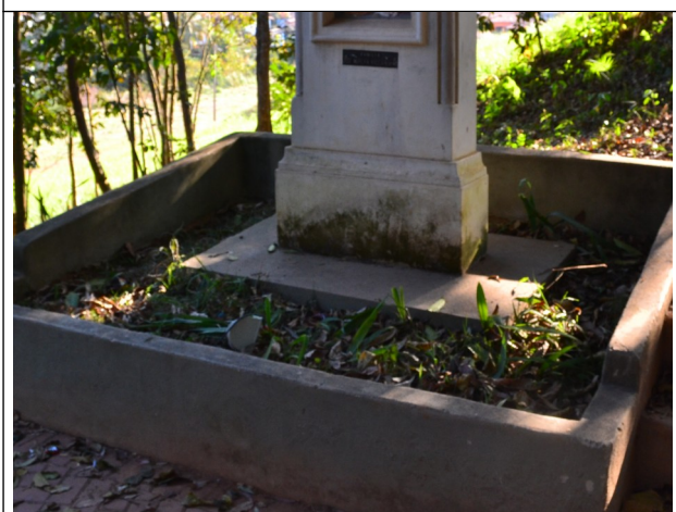
Figura 07 – Mancha de umidade na base da estação.
