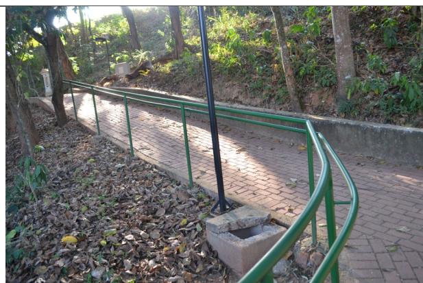
Figura 04 - Caixa de passagem quebrada, guarda corpo em modelo diferente do existente em projeto (grande distanciamento entre as travessas).
