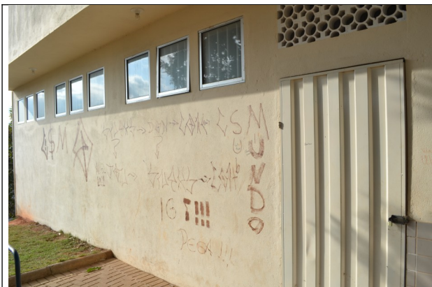
Figura 01 – Pichações e inscrições nas alvenarias externas dos banheiros.
