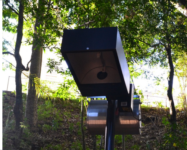
Figura 13 – Luminária com lâmpada quebrada.
