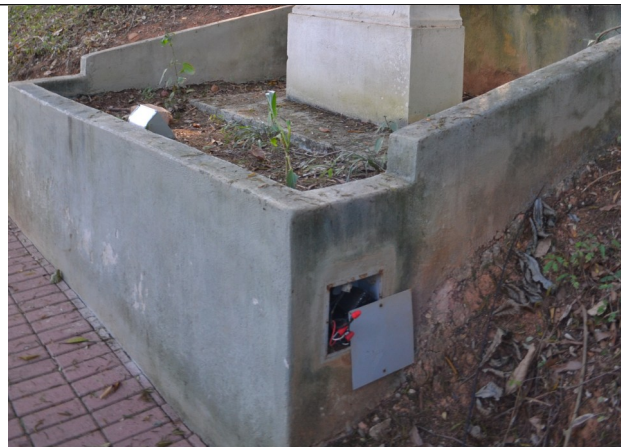
Figura 15 – Dano na tampa da caixa de eletricidade. Descolamento do reboco.
