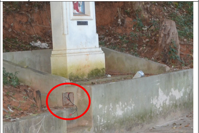
Figura 16 - Dano na tampa da caixa de eletricidade. Manchas de umidade.
