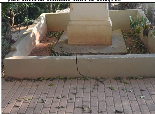
Figura 08 – Trinca no meio fio existente no entorno da base da estação. Ausência de tratamento paisagístico do canteiro existente na base.
