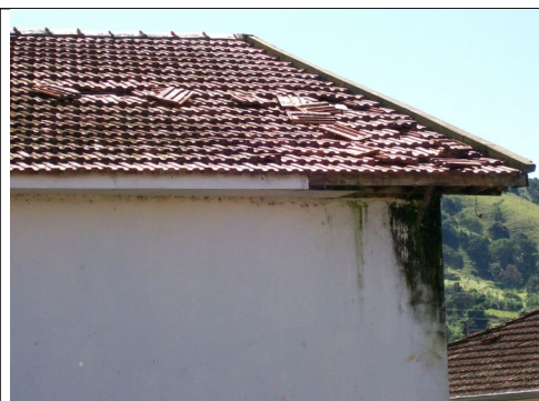
Figura 30 – Telhas soltas e marcas de infiltração
