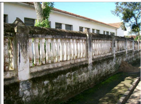
Figura 43 – Bolor e sujidades no muro.
