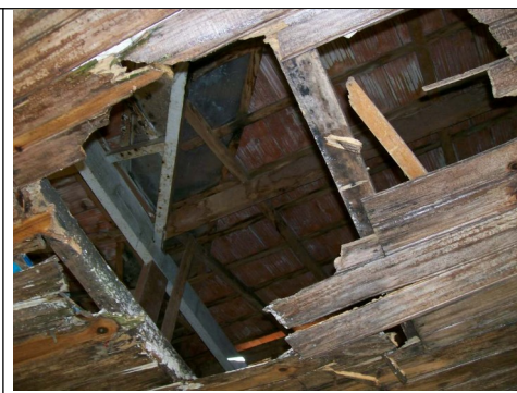
Figura 32 – Forro de lambris de madeira que desabou.
