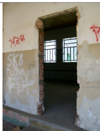
Figura 34 – Pichação e falta de esquadria
