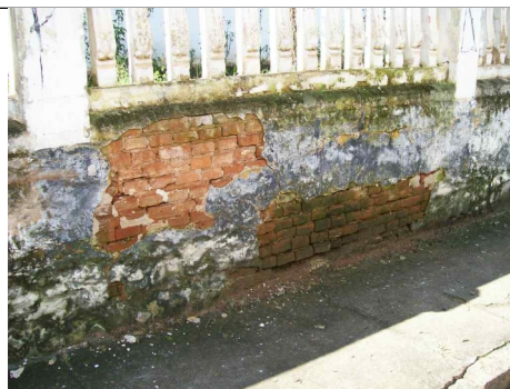
Figura 42 – Descolamento do revestimento do muro
