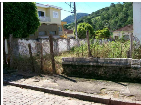
Figura 41 – Trecho do muro que desabou
