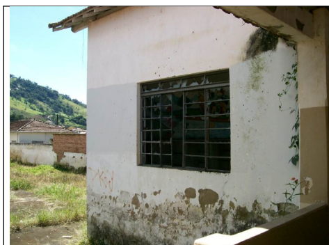
Figura 44 – Sujidades e descolamento de pintura
