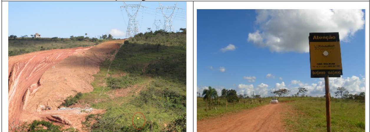
Figura 16 e 17- Terreno de realização das obras, destacando movimentação de terra, presença de torres de transmissão de energia ao fundo e placa indicando existência de gasoduto (assinalada de vermelho na 1ª imagem).
