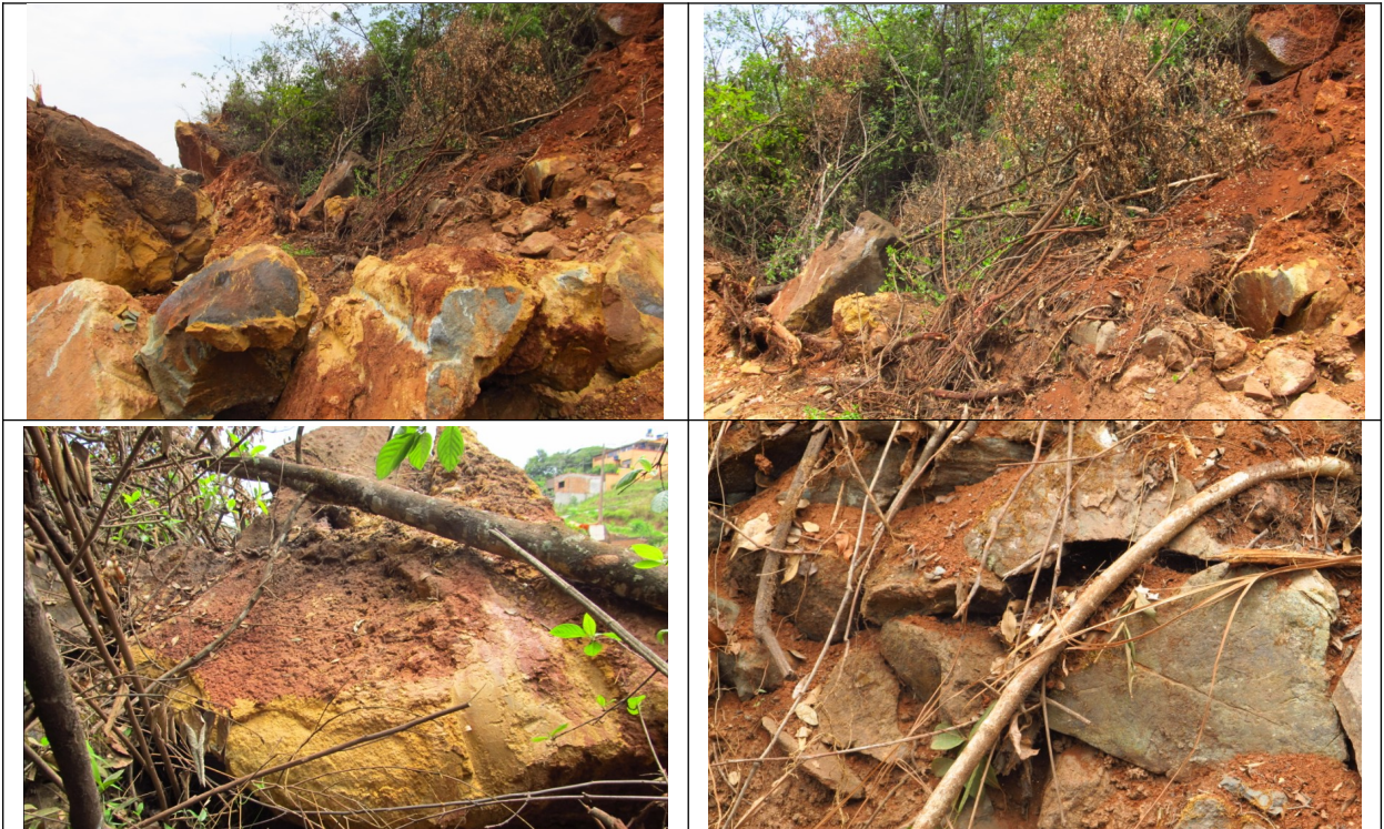
Figuras 15, 16, 17 e 18- Impactos causados pelas obras do condomínio Goiabeiras no antigo canal existente na área.
