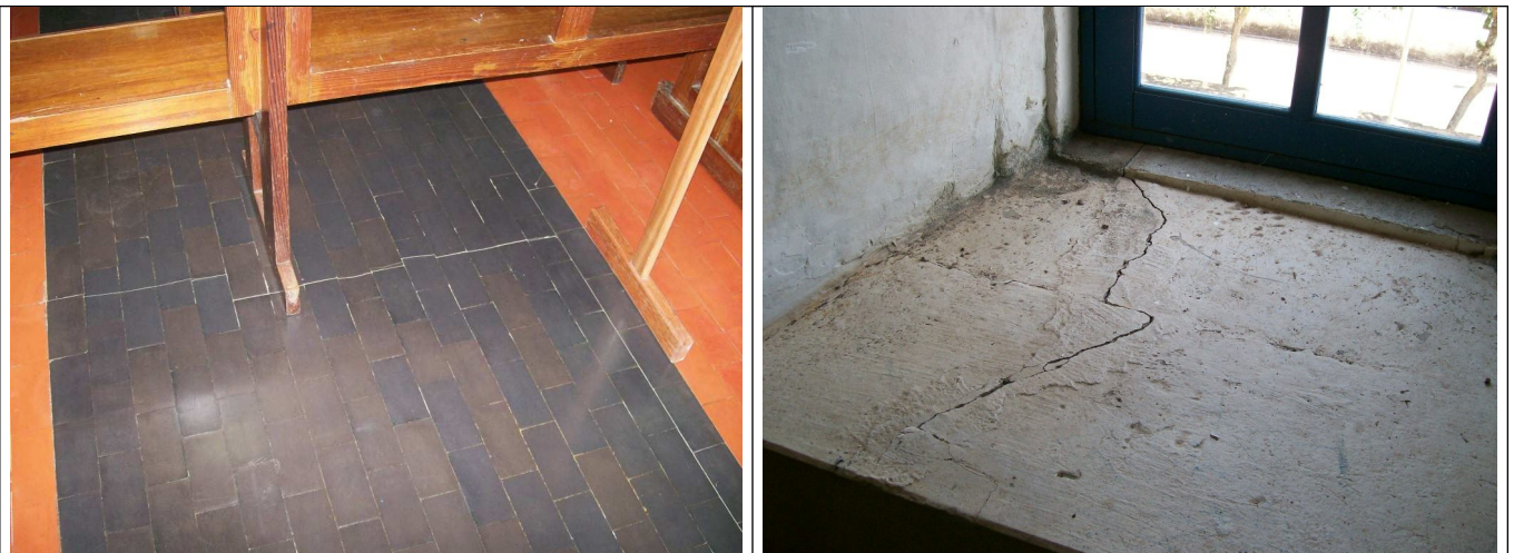
Figuras 11 e 12– Trincas no piso e peitoril.
