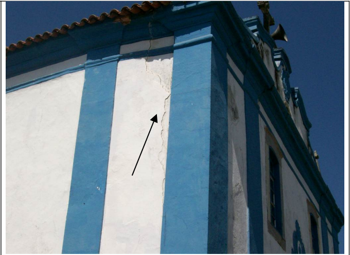
Figura 14 – Trinca e abaulamento da fachada.
