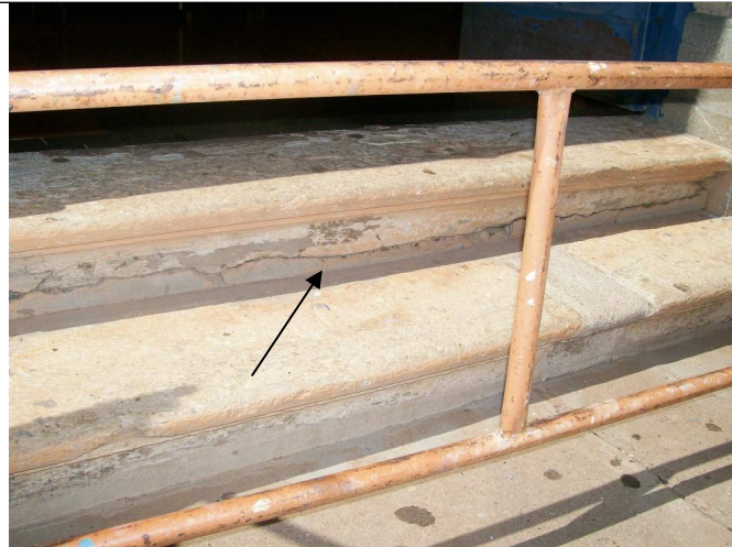
Figura 13 – Trinca no espelho da escada.
