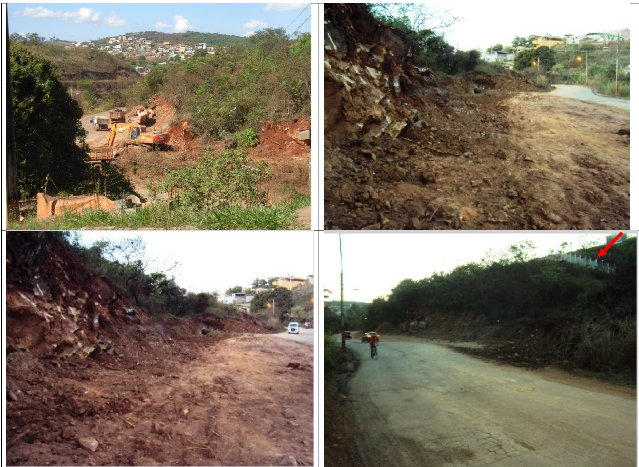
Figuras 6, 7, 8 e 9- Fotografias encaminhadas a esta Promotoria em 09 e 10/10/2012. Na última foto o muro do Condomínio Goiabeiras está assinalado com a seta vermelha.
